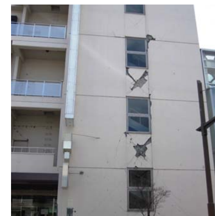
耐力壁開口周辺のせん断破壊
