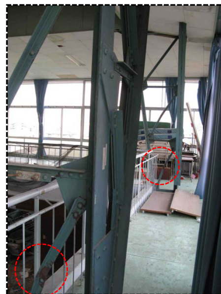
ラチス柱斜材の座屈
