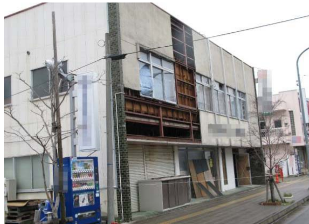
外装パネルの脱落
