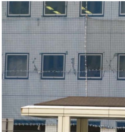
タイルの破損
