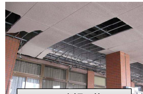
天井の破損・落下
