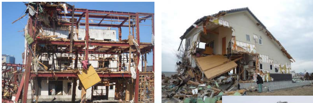
波圧や漂流物の衝突による外装材等の被害
