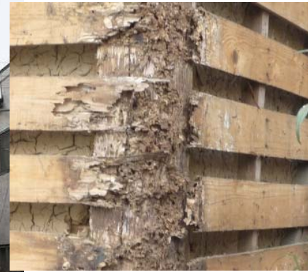
部材の腐朽・劣化を伴う被害
