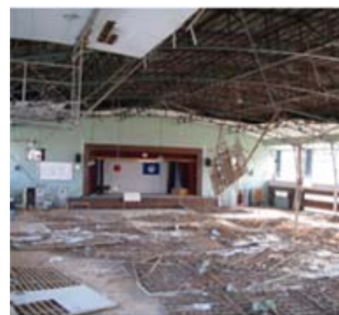
天井材・外装材の脱落
