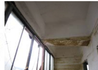
写真4 建物1階の浸水痕
