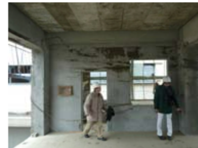
写真3 建物1階の浸水痕
