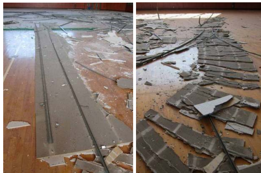
脱落した天井部材
