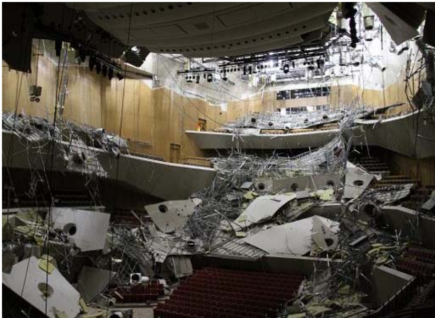
音楽ホールにおける天井の脱落
