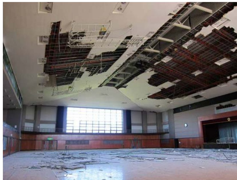
体育館における天井の脱落
