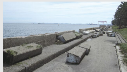
令和元年台風第15号の高波による護岸の被災
