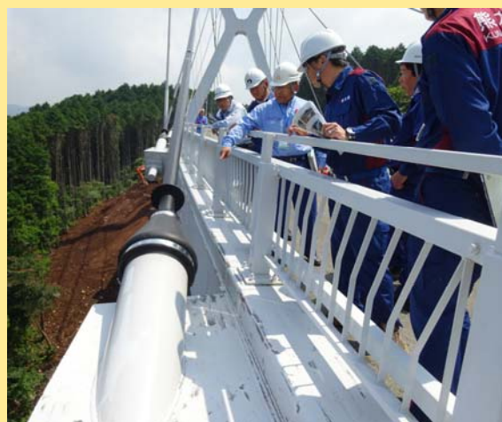
取り替えたケーブルと定着部の多重の防水対策について 管理者である熊本県職員に対して現地説明
