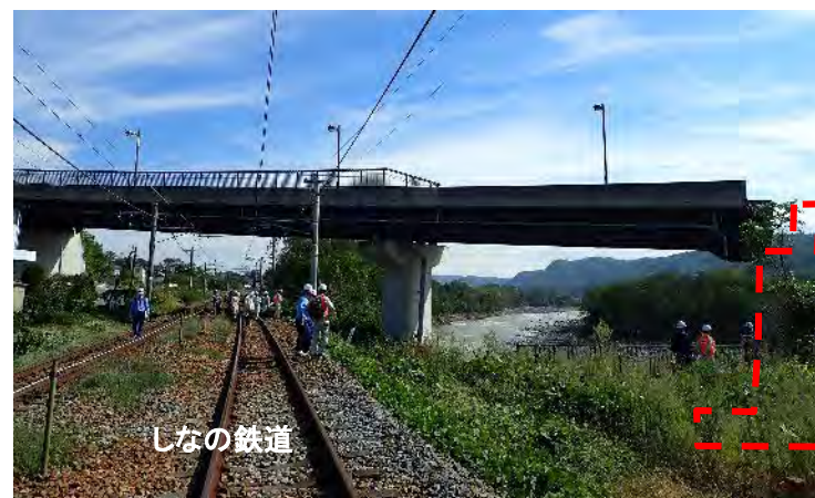
A2橋台が転倒
