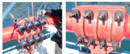
ケーブルバンドボルトの交換（軸力導入状況と交換完了状況）
