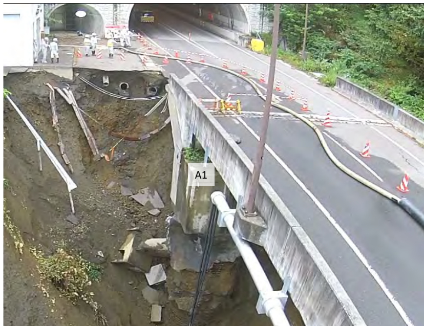
令和元年度台風19号の被害 (国道361号権兵衛2号橋) 【約2ヶ月間の通行止めを実施】
