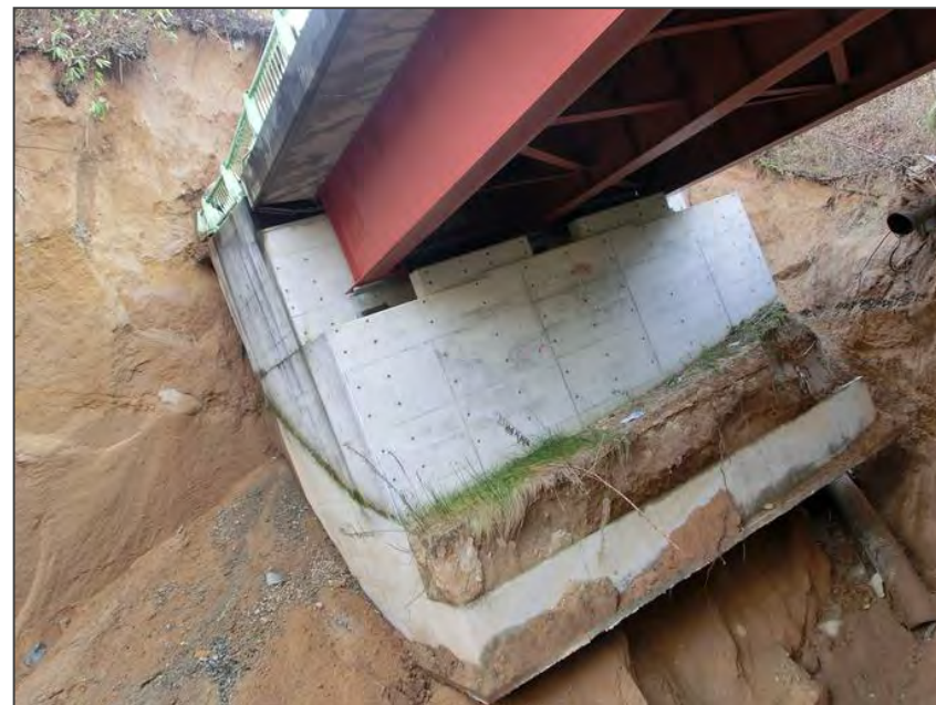
平成26年の直接基礎の被害 (町道成香15号線伏見橋)
