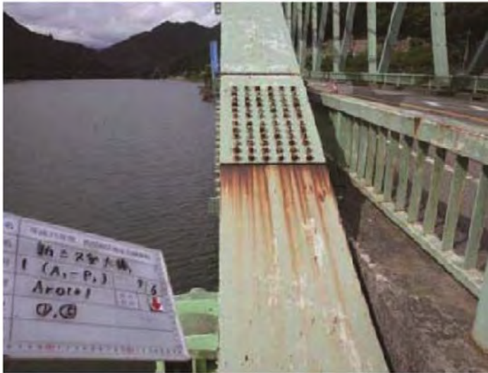
連結板周辺は滞水により腐食が発生しやすい
