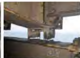
▲シェッド主梁端部破断
