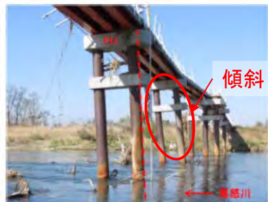
令和元年台風19号の被害 (上三川町道 2-45号線 東蓼沼橋)
