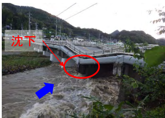
令和元年台風19号の被害 (国道20号法雲寺橋)
