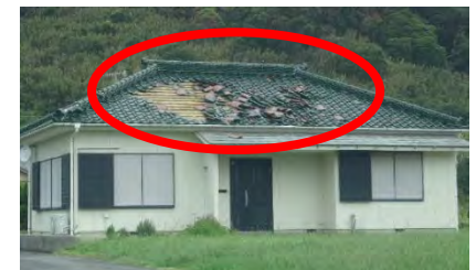
現行の告示基準で 緊結対象とはなっ ていない平部での被害
