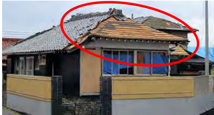
屋根瓦の飛散・脱落
