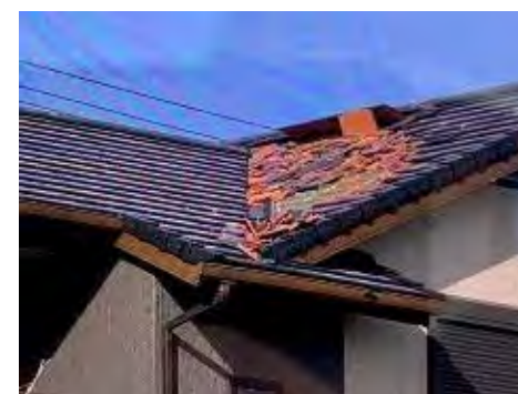
沿岸部で被害が発生 したガイドライン工法 による瓦屋根
