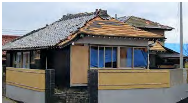
一面の瓦が全面的に落下
