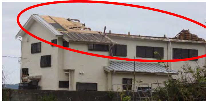
木造小屋組の損壊
