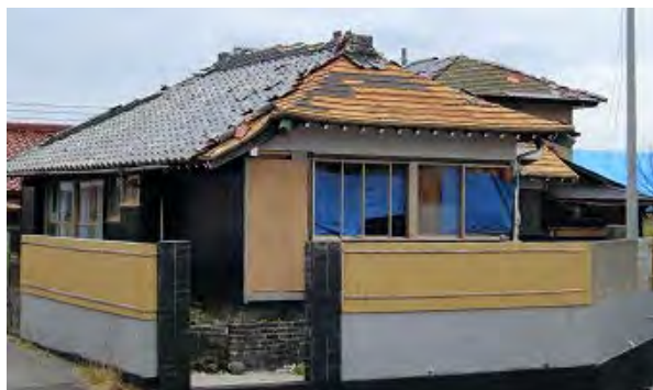
被害が発生した 非ガイドライン工法 による瓦屋根
