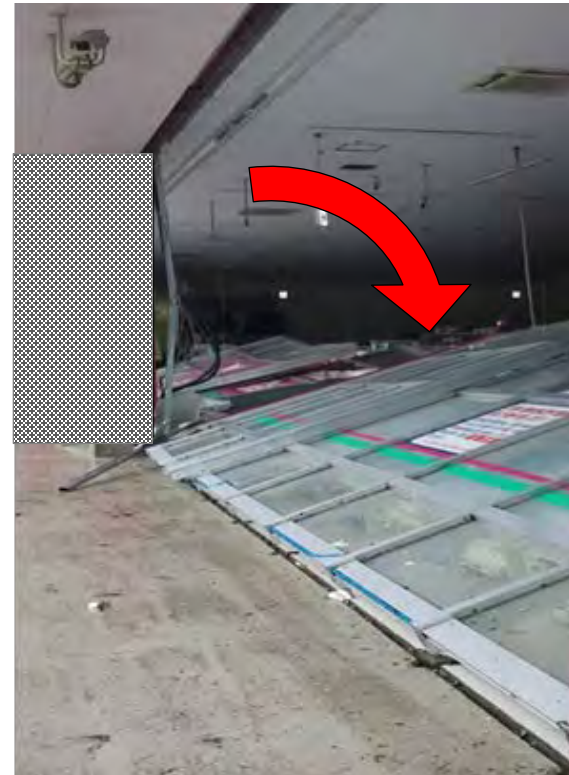
低層店舗等の屋外に面する建具 (フロントサッシ)の脱落・転倒
