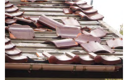
築年数が経った 瓦屋根の被害
