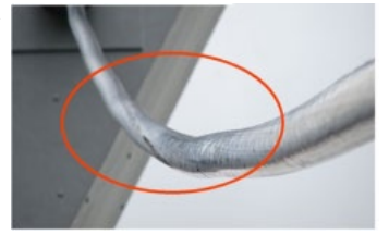
④ケーブルのよれ
