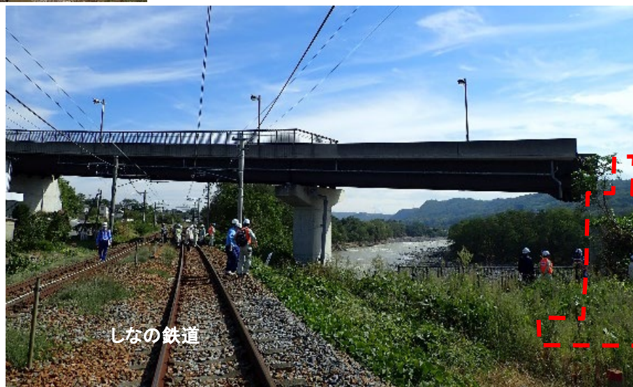
橋台の転倒(直接基礎)
