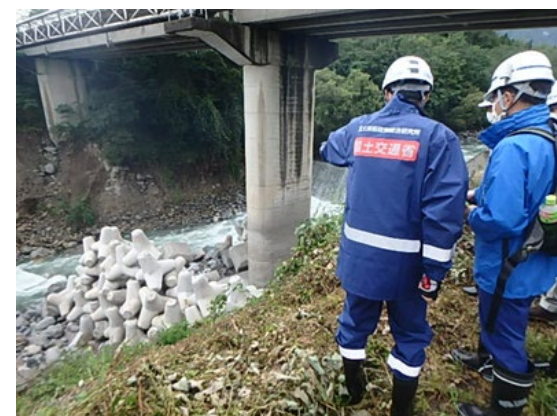
令和3年8月21日 大雨による洗掘被害を受けた 新大田切橋に対し技術支援を実施
