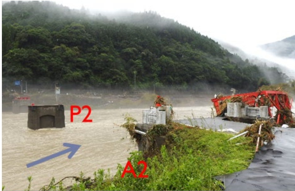
令和2年7月球磨川豪雨の被害 (熊本県道325号 相良橋)
