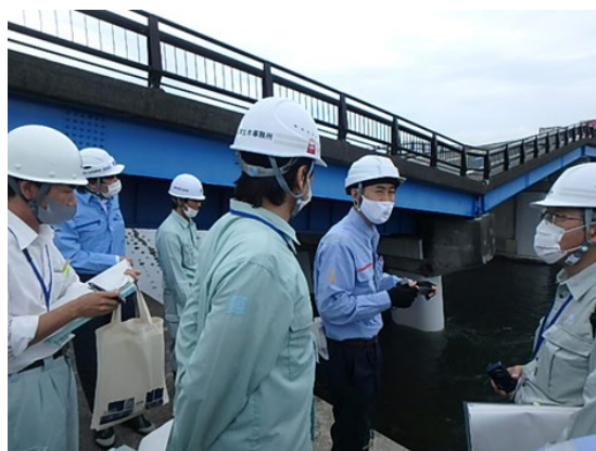
令和3年7月6日派遣 豪雨による洗掘被害を受けた 黄瀬川大橋に対し技術支援を実施
