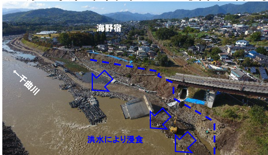
橋梁の流出状況
