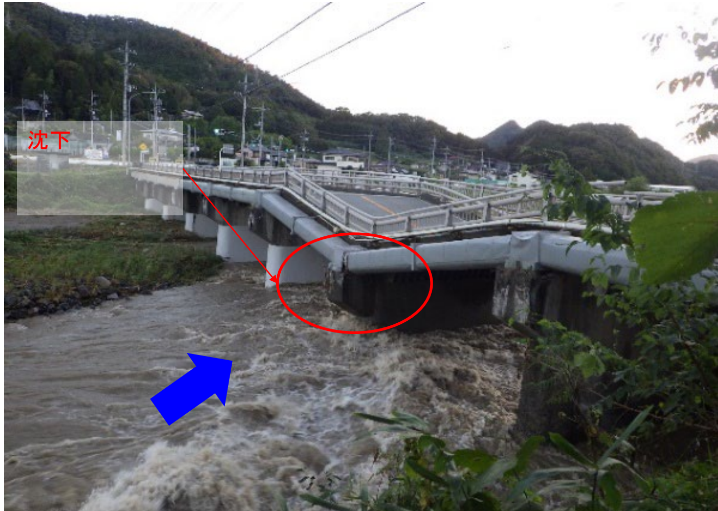
直接基礎の沈下
