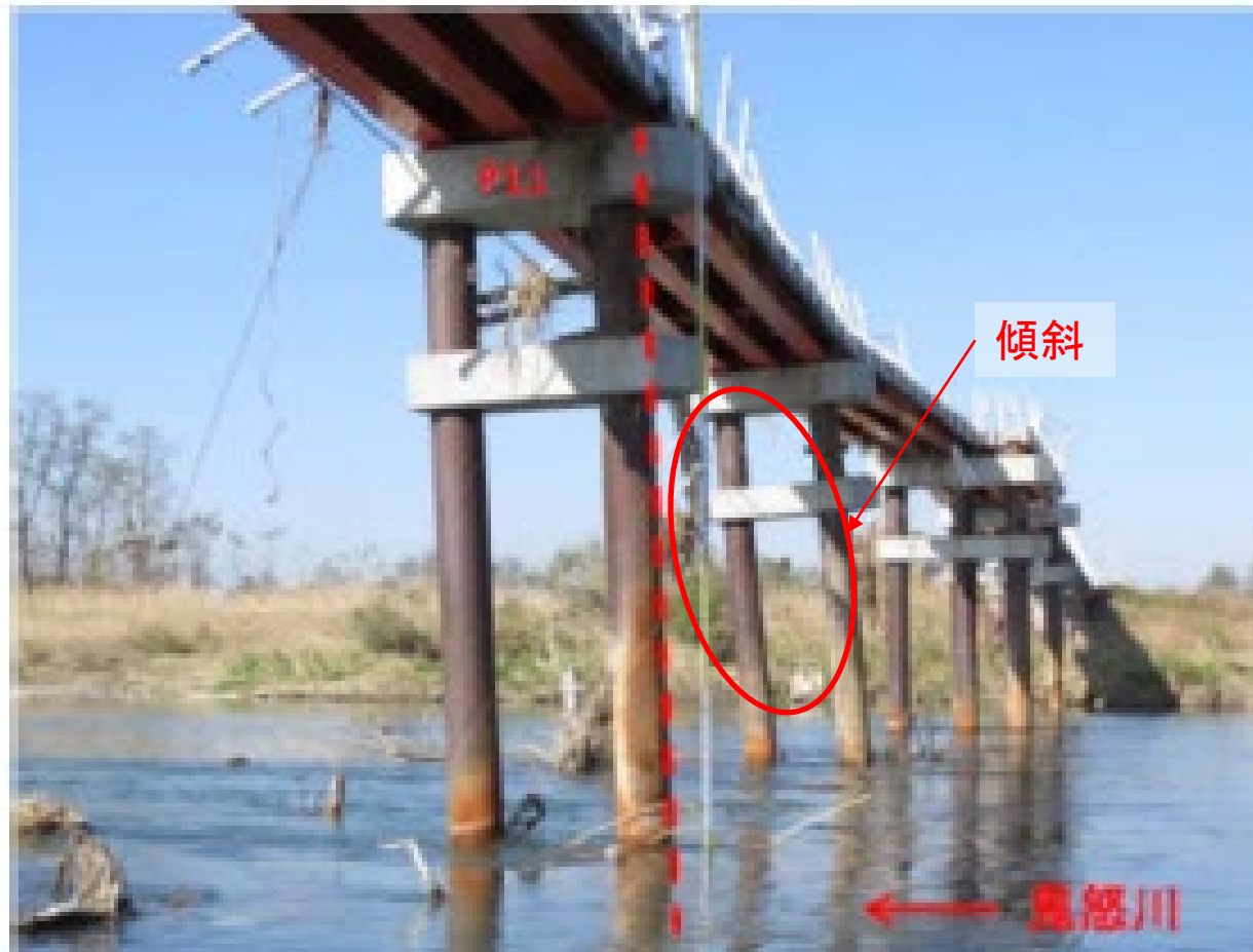
パイルベント橋脚の傾斜
