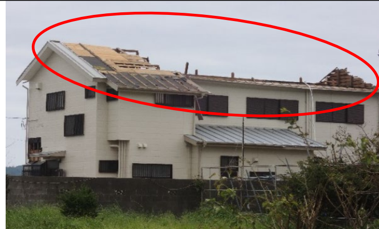
木造小屋組の飛散(令和元年房総半島台風・館山市)
