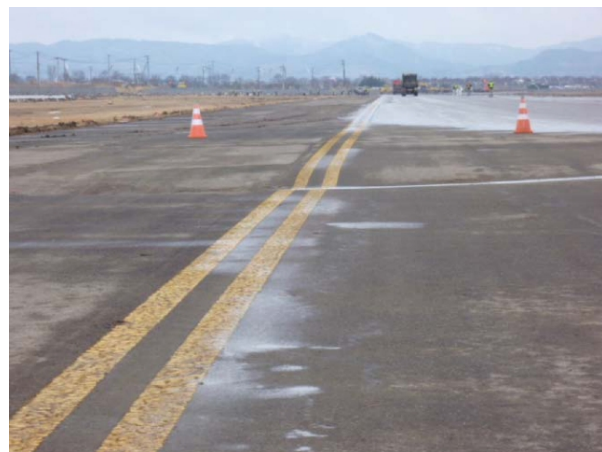
沈下による路面標識の乱れ
