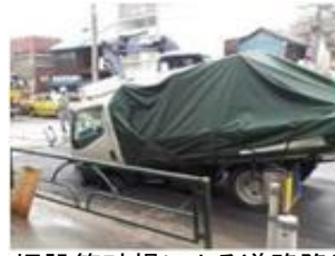
埋設管破損による道路陥没
