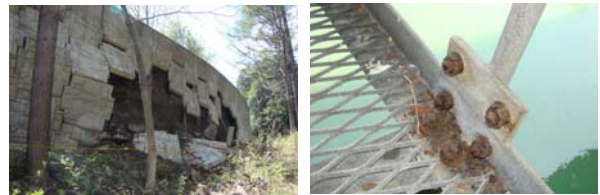
補強土擁壁の崩落
