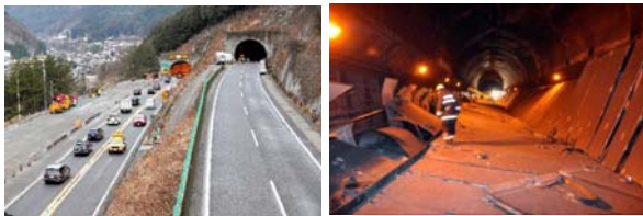
トンネル天井版の落下
