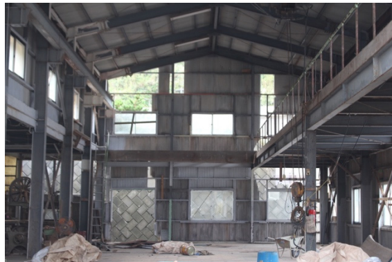
写真 5. 1. 9 鉄骨造の元造船所 A の被害 (内部)
