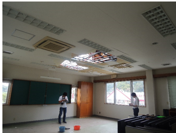
写真 4.1.17 2階天井の被害状況
