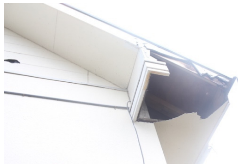
写真 5. 2. 29 写真 5. 2. 28 の住宅の軒天井の被害
