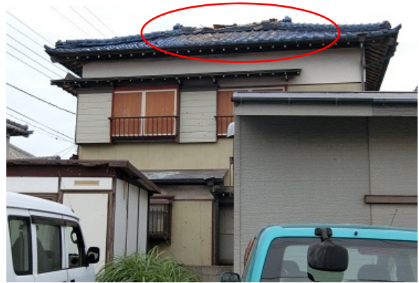
写真 4.3.30 棟瓦のみが落下した例
