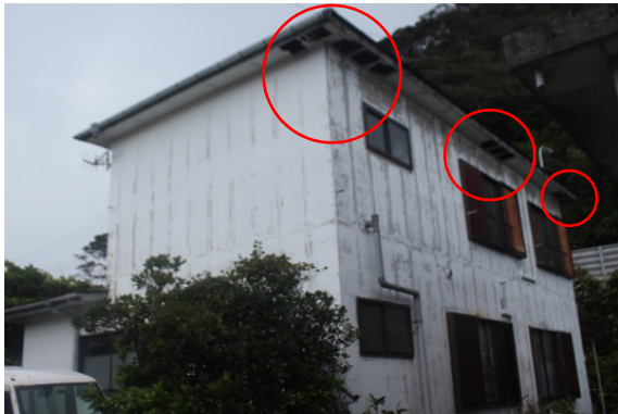
写真 5. 2. 18 住宅の軒被害
