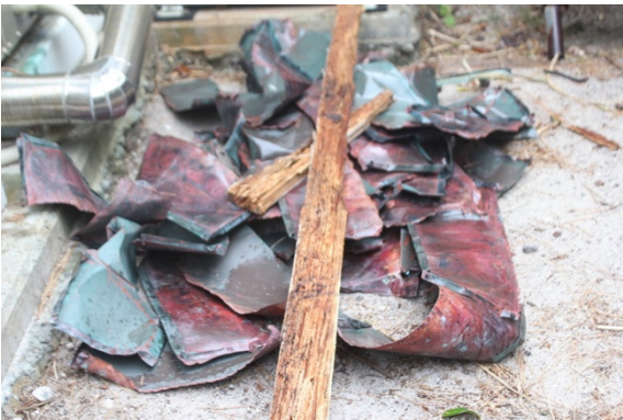
写真 5.1.56 脱落した屋根ふき材
