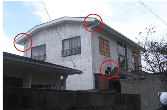
写真 5. 2. 19 住宅の軒と外壁被害
