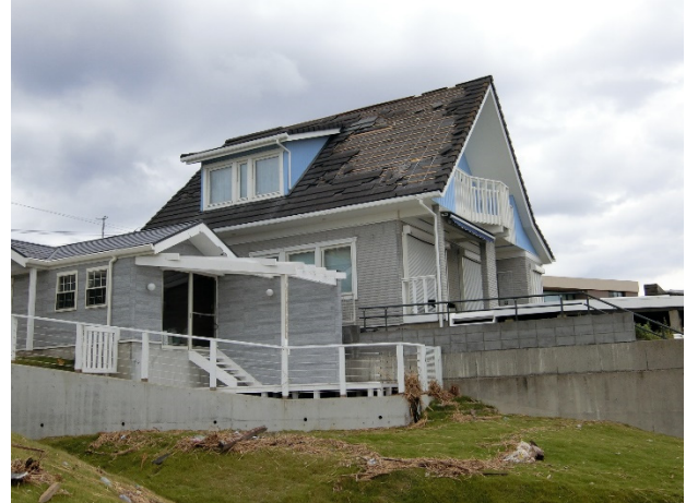
写真 4.3.73 屋根ふき材の脱落
