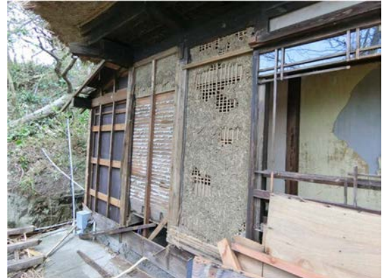
写真 4.3.55 写真 4.3.54 の住宅の外壁の被害
