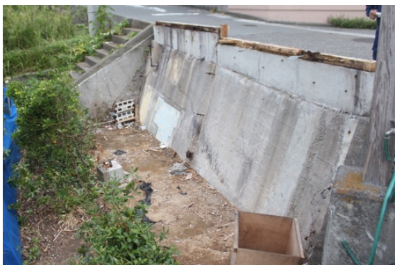
写真 5.1.27 倒壊して撤去された ゴミ捨て場の跡
