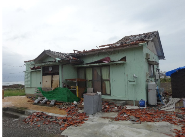
写真 4. 2. 33 屋根の被害状況
