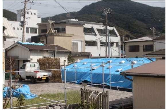
写真 5.1.41 住宅の屋根の被害
