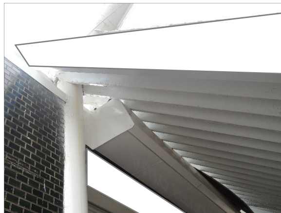
写真 4.3.20 キャノピーを支持する柱の折損(1)
