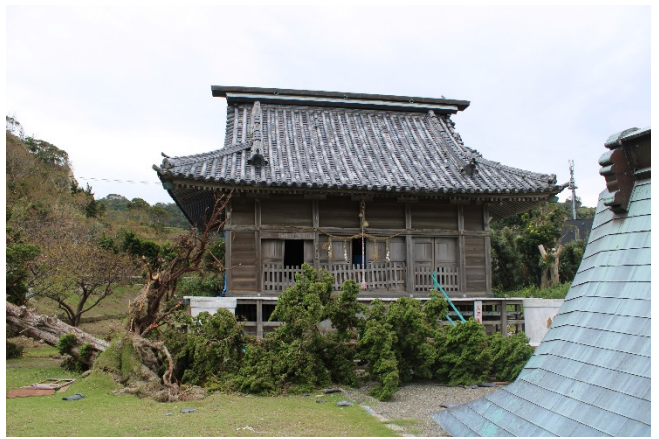
写真 4. 3. 49 社殿の残留変形
