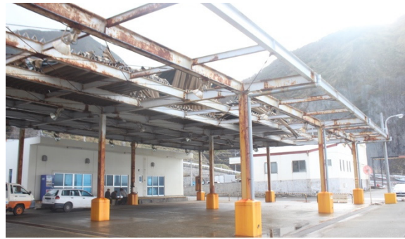
写真 5.2.31 漁港施設 A の屋根被害
