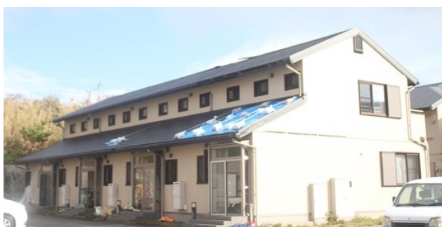
写真 5. 2. 28 共同住宅の屋根と軒の被害
