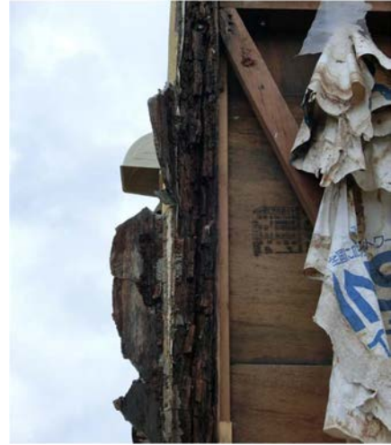
写真 4. 3. 62 写真 4. 3. 61 右側の躯体の生物劣化
