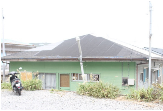
写真 5. 1. 51 屋根ふき材の被害
