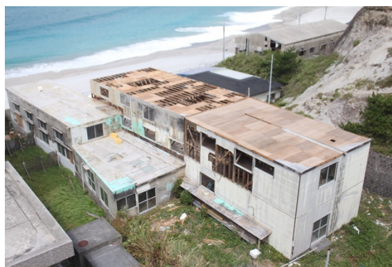
写真 5. 1. 11 元造船所の被害 (手前が元造船所 A、奥が元造船所 B)
