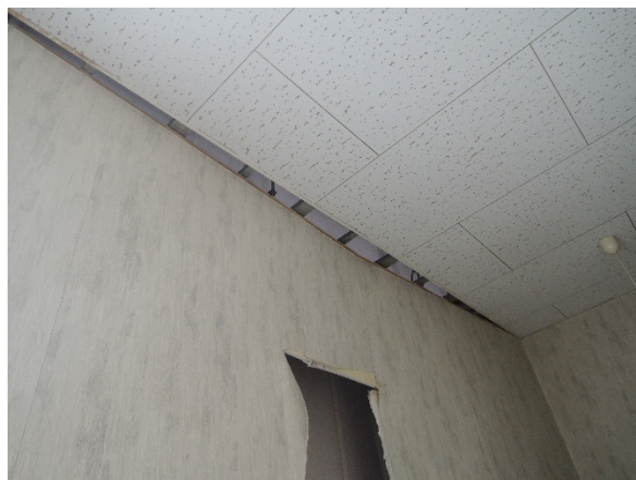
写真 4.1.19 階段室の壁材の変形
