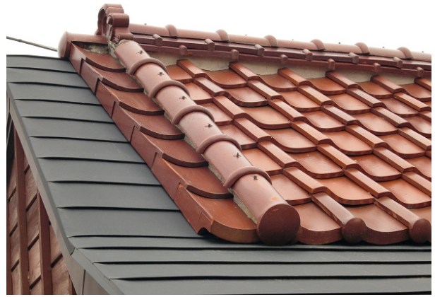
写真 4.3.36 緊結され、無被害であった隅棟部の瓦
