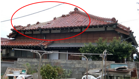
写真 4.3.31 寄棟における隅棟部の瓦の落下
