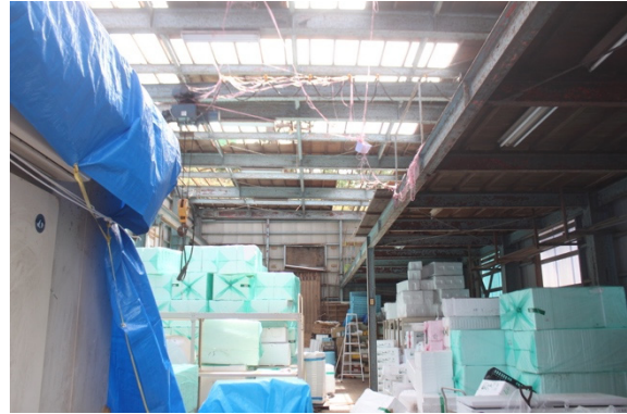
写真 5. 1. 15 鉄骨造の元造船所 C の被害
