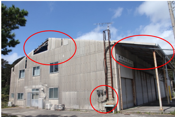
写真 5.2.4 空港の近くの工場の被害
