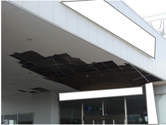
写真 4.3.1 店舗 H の軒天井の被害
