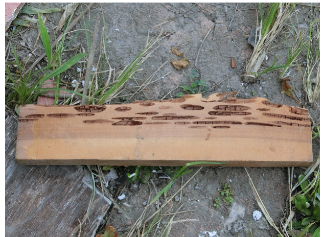
写真 4. 3. 66 写真 4. 3. 61 左側の住宅の蟻害を受けた部材
