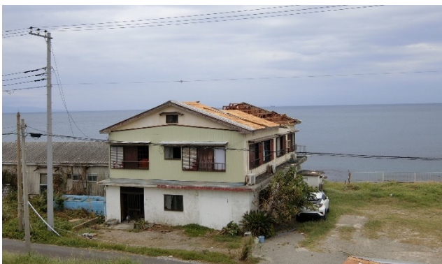
写真 4. 3. 41 屋根が飛散した海沿いの木造住宅
