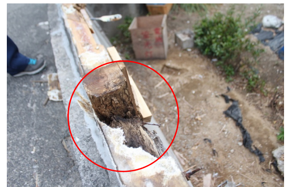
写真 5.1.28 ゴミ捨て場の土台の腐朽・蟻害
