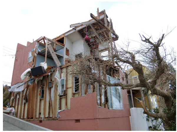
写真 4. 3. 64 写真 4. 3. 61 左側の住宅の外壁の崩落
