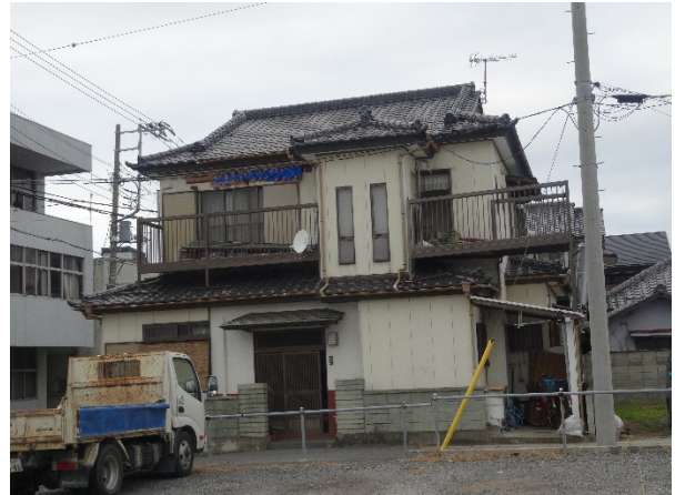
写真 4.1.28 隣接する住宅の被害状況
