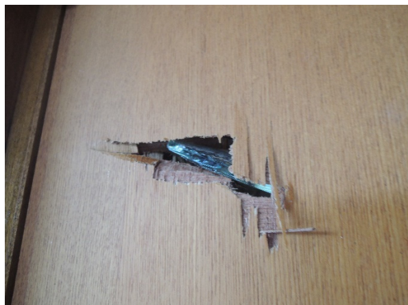
写真 4.1.20 窓ガラス破片のドアへの貫通 (室内側から見る)
