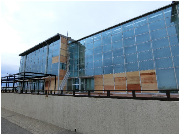
写真 4.1.1 破損した窓ガラスの状況
