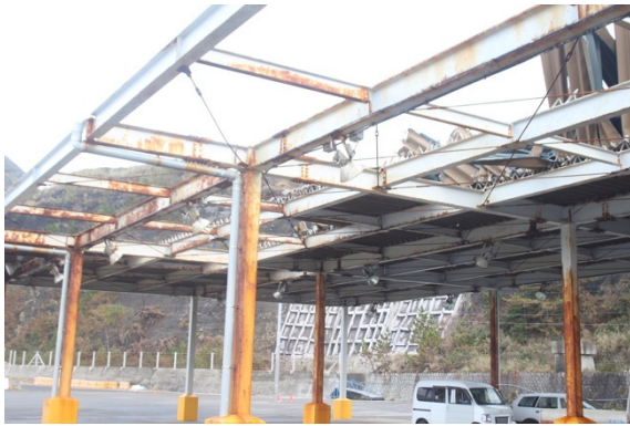
写真 5.2.32 漁港施設 A の屋根被害
