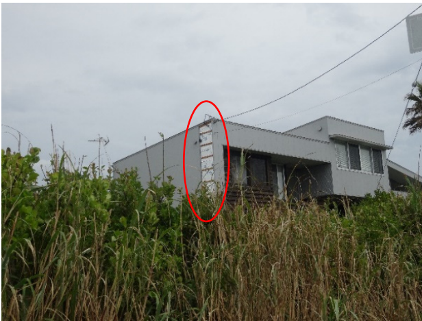
写真 4. 2. 30 住宅の隅角部での被害状況(1)
