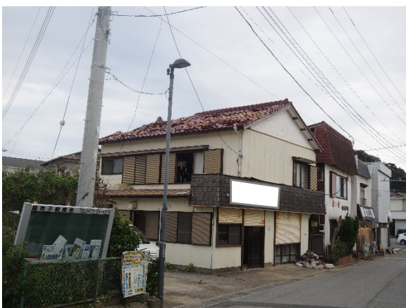
写真 4.1.9 店舗併用住宅での屋根瓦の被害
