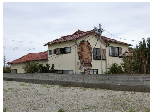
写真 4.3.38 モルタル外壁が剥落した宿泊施設 E
