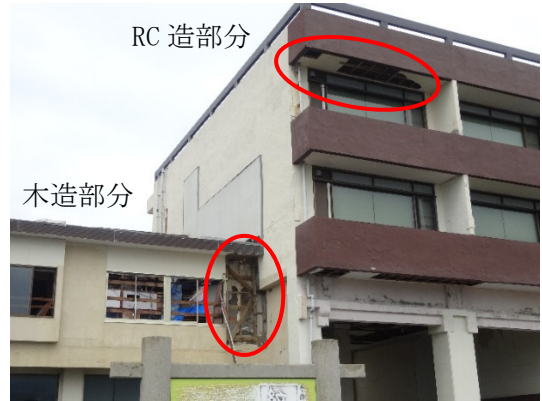
写真 4. 2. 20 外壁と軒天井の被害状況
