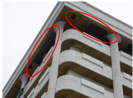
写真 4. 2. 24 最上階の軒天井の被害
