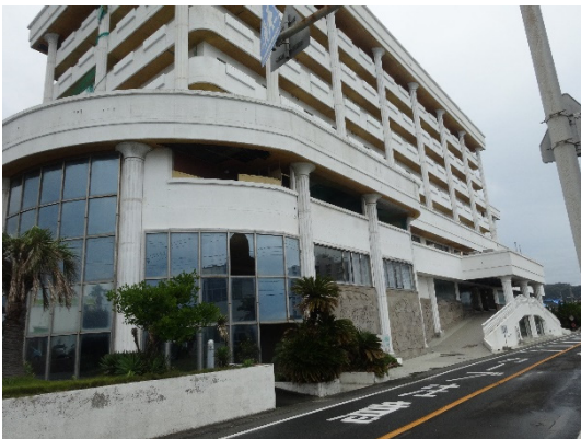
写真 4. 2. 21 屋根・軒天井の被害(被災後)
