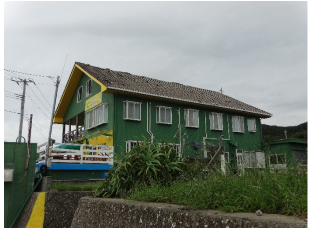
写真 4.2.26 屋根瓦の被害(風下側)
