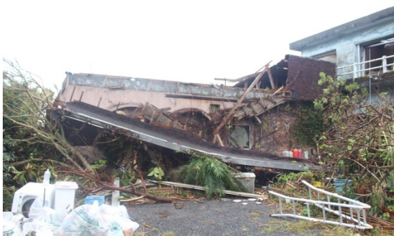
写真 5. 2. 24 倒壊した店舗 D
