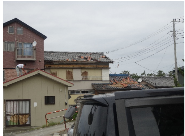
写真 4.3.8 隣接する住宅での瓦の被害
