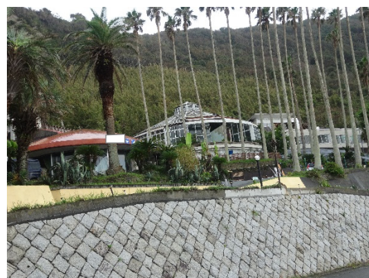
写真 4.2.18 宿泊施設Aの屋根・ 窓ガラスの被害状況
