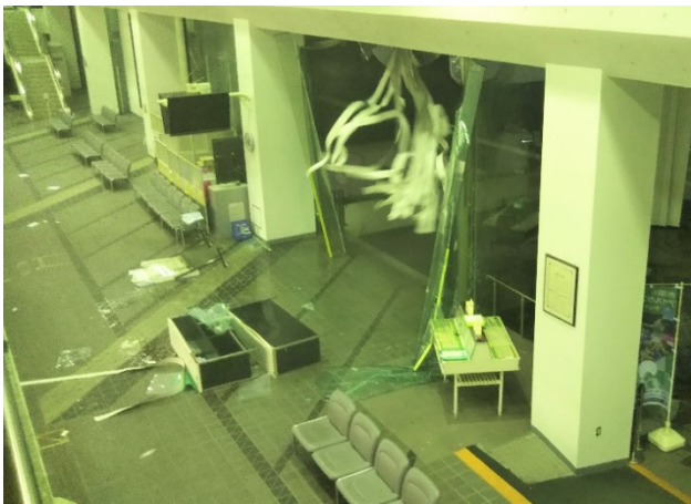
写真 3.4 第2庁舎南面入り口付近の被災直後の状況(1) (市原市提供)
