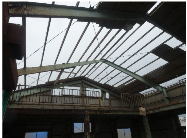
写真 4.2.28 屋根・窓ガラスの被害
