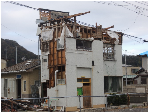
写真 4.1.27 木造住宅の被害状況
