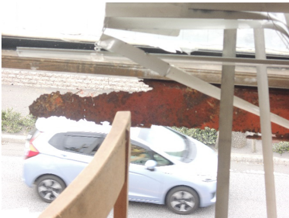
写真 4.3.7 腐食によって板厚が減少した鋼製部材
