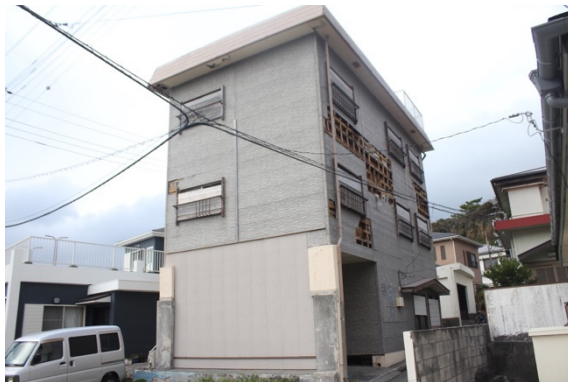
写真 5. 1. 53 住宅の壁被害
