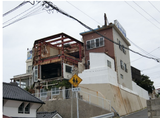
写真 4. 3. 40 宿泊施設 F の外壁の脱落状況
