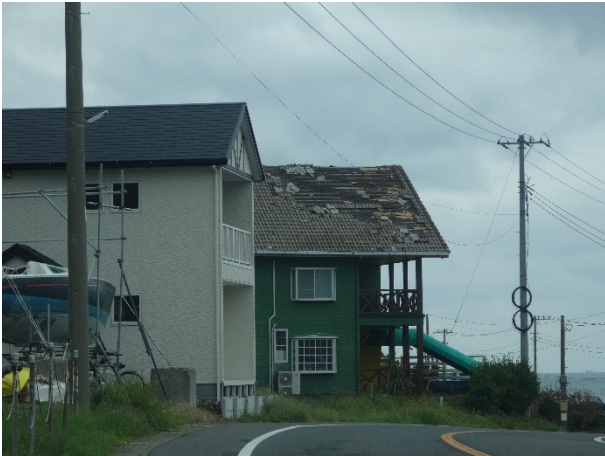
写真 4.2.25 屋根瓦の被害(風上側)
