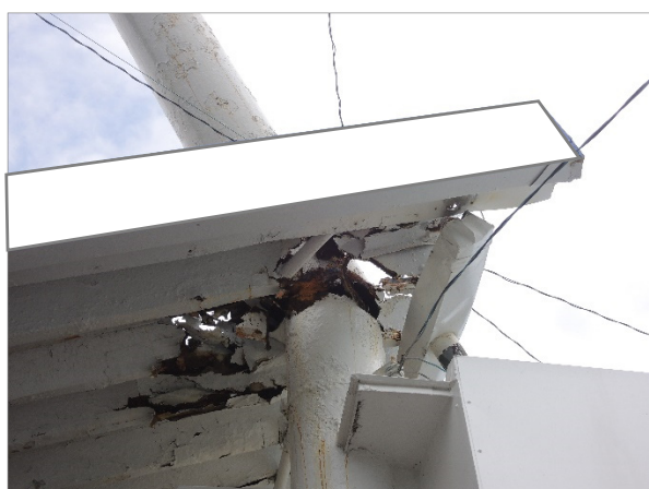
写真 4.3.21 キャノピーを支持する柱の折損(2)
