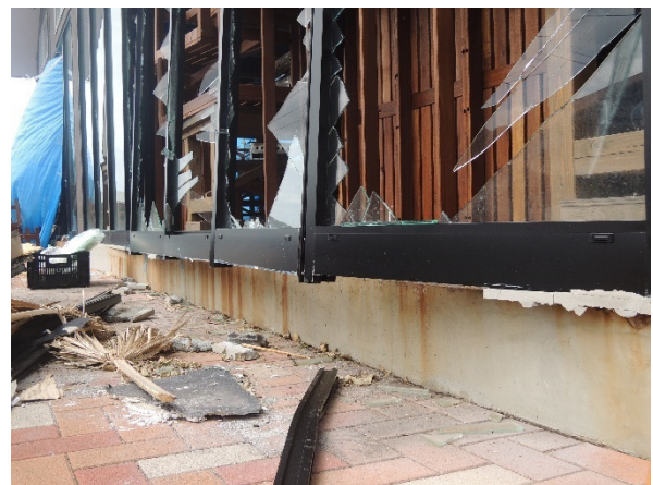
写真 4.2.2 屋外に面する建具の損壊(2)
