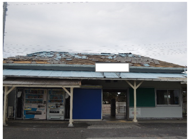
写真 4.1.8 駅舎での屋根瓦の被害
