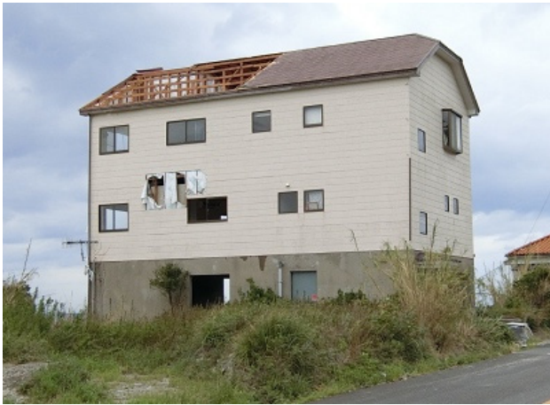
写真 4.3.67 屋根が飛散した海岸沿いの混構造 3階建て住宅
