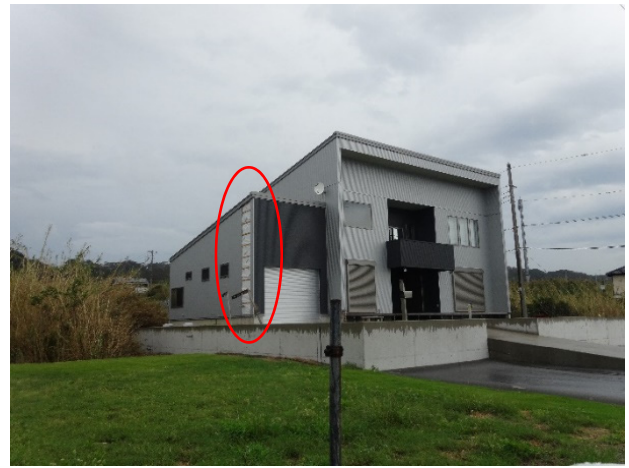
写真 4. 2. 31 住宅の隅角部での被害状況(2)
