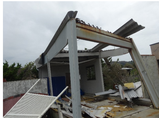
写真 4. 2. 40 軽量鉄骨造車庫の 屋根の飛散と柱の倒壊
