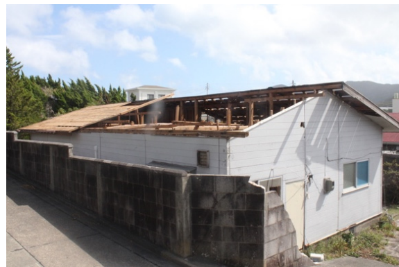
写真 5.2.9 住宅の屋根被害
