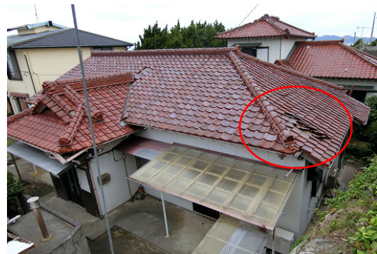
写真 4.3.32 平瓦の部分的なずれ又は破損
