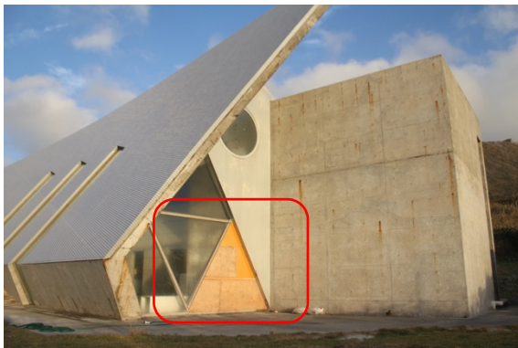
写真 5.2.37 西側の海岸に面する美術館のガラスの破損
