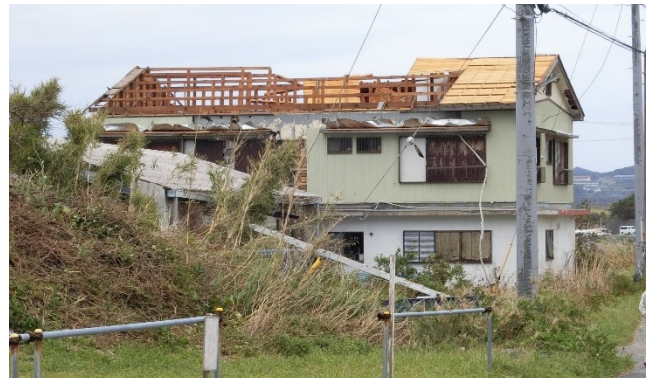
写真 4. 3. 42 小屋組の損傷状況
