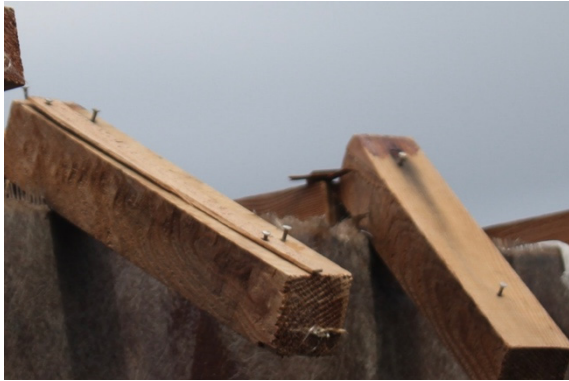
写真 5. 1. 14 屋根材を留め付けていた釘
