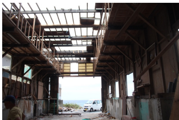
写真 5. 1. 12 木造の元造船所 B の被害 (内部)
