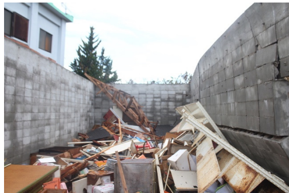
写真 5. 2. 23 倒壊した倉庫 B の内部
