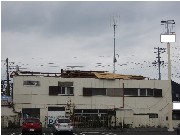
写真 4.2.9 店舗 G の小屋組の損壊(1)
