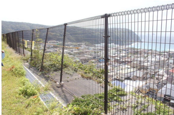
写真 5.1.7 フェンスの被害
