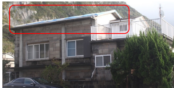
写真 5.2.35 住宅の屋根被害(2)
