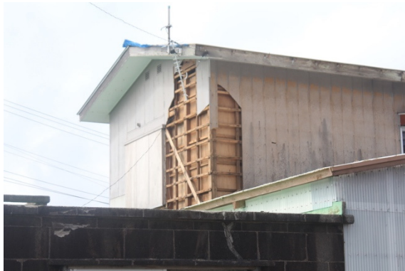
写真 5.2.12 店舗兼住宅の外壁被害
