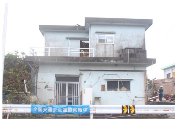
写真 5. 2. 25 住宅の屋根被害
