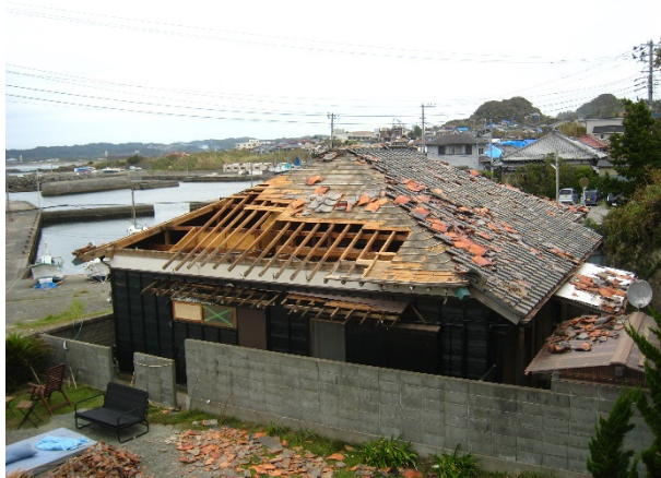
写真 4. 3. 45 野地板が飛散した木造住宅
