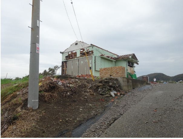
写真 4. 2. 32 屋根と外壁の被害
