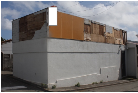
写真 5.2.10 店舗Cのパラペットの被害
