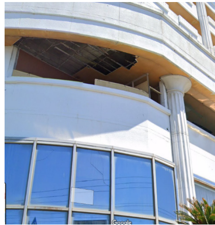
写真 4. 2. 22 被災前の軒天井・窓ガラスの状況 (Google ストリートビュー(2019年5月撮影)より)
