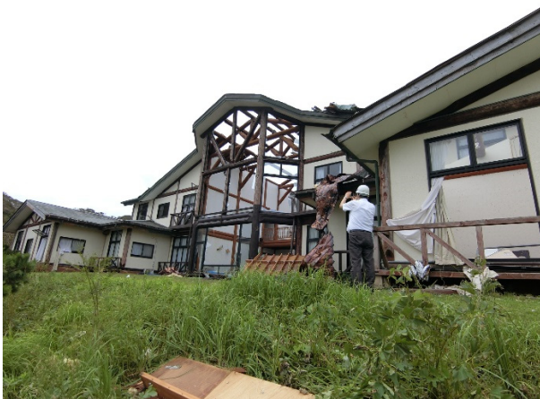
写真 4. 3. 50 窓ガラスの破損
