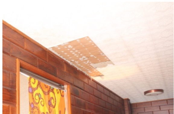
写真 5. 1. 50 雨漏りの被害
