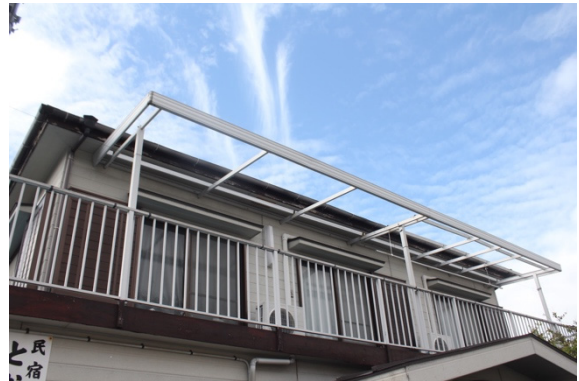
写真 5.1.43 住宅の庇の被害
