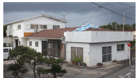
写真 5.2.15 住宅兼作業場の屋根被害
