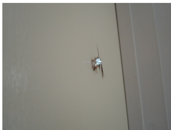
写真 4.1.21 窓ガラス破片のドアへの貫通 (廊下側から見る)
