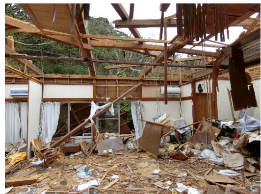
写真 4.3.57 宿泊施設 H の屋根の飛散
