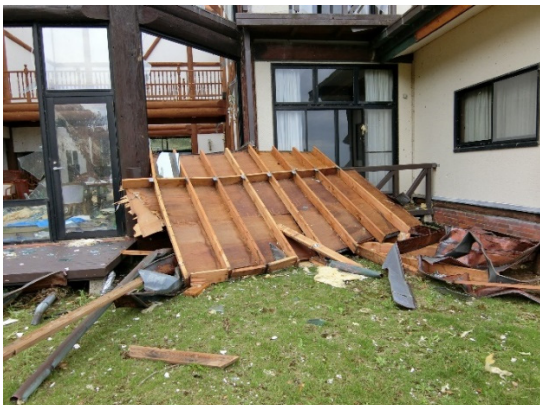
写真 4. 3. 52 脱落した屋根
