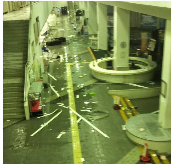
写真 3.5 第2庁舎南面入り口付近の被災直後の状況(2) (市原市提供)
