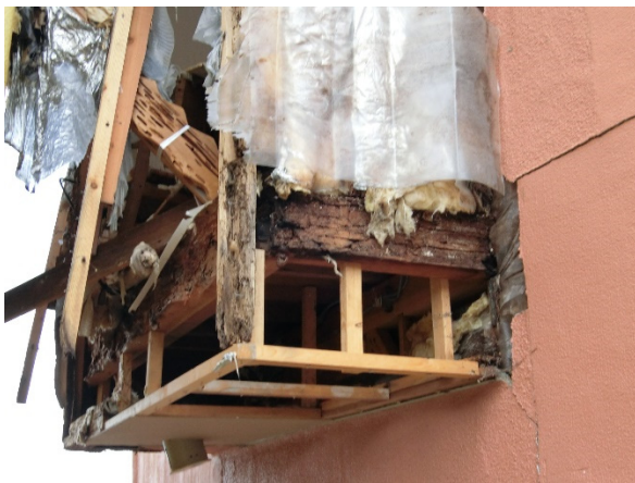
写真 4. 3. 65 躯体に生じた著しい腐朽・蟻害
