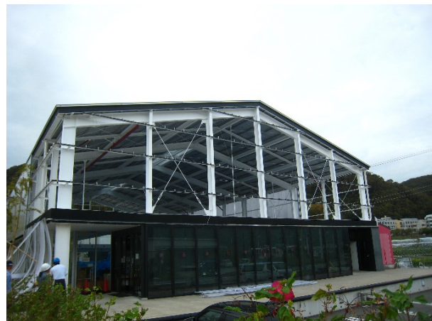
写真4.1.14 全ての外壁材が飛散した妻面
