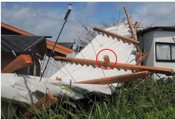
写真 4.2.7 飛散した小屋組
