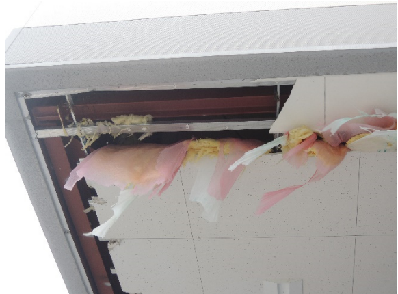
写真 4.3.14 軒天井の損傷
