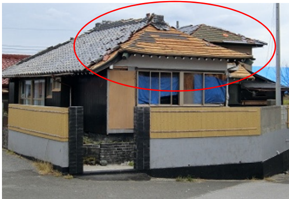
写真 4.3.29 寄棟の一面の瓦が全面的に落下した例
