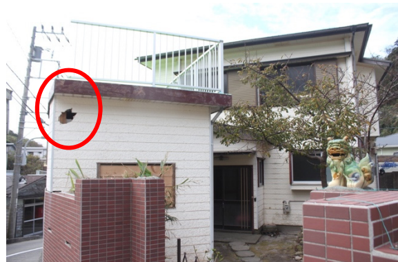
写真 5. 1. 48 飛来物による東面の壁の破損
