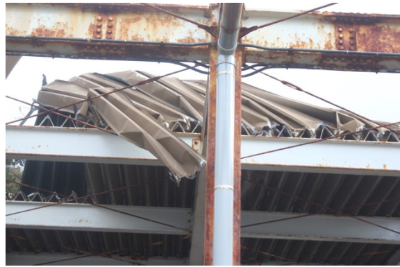
写真 5.2.33 風で捲れた屋根材
