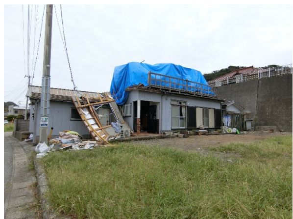
写真 4. 3. 44 南西へ壁が脱落した 2 階建て木造住宅
