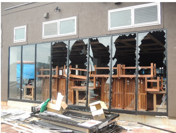
写真 4.2.1 屋外に面する建具の損壊(1)
