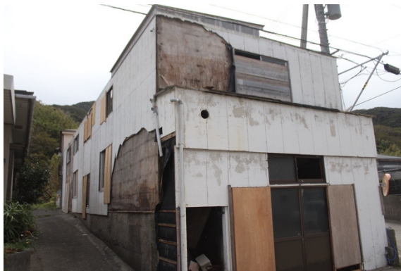
写真 5. 1. 31 壁に被害を受けた住宅
