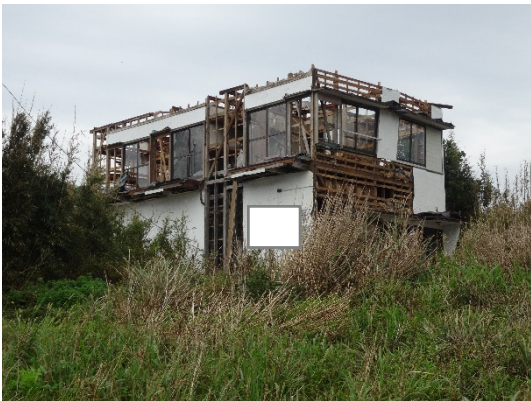
写真 4. 2. 39 木造住宅の屋根の飛散と外壁の被害
