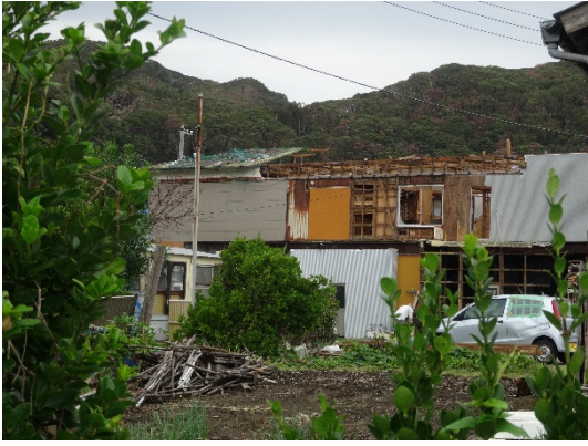
写真 4. 2. 37 木造住宅の屋根と外壁の被害
