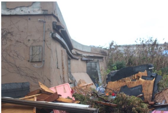
写真 5. 2. 22 倒壊した倉庫 B
