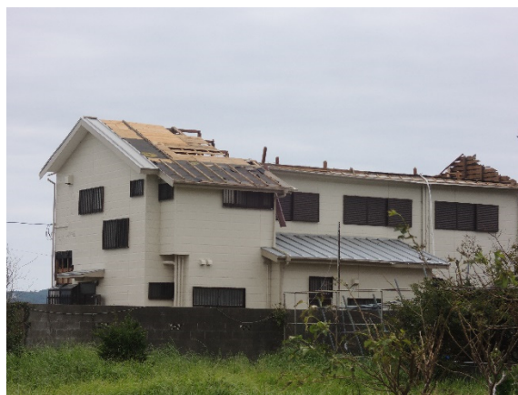
写真 4. 3. 24 木造住宅の小屋組の損壊(2)
