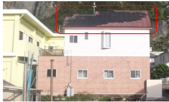
写真 5.2.37 住宅の屋根被害(4)
