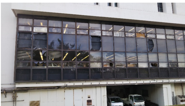
写真 3.6 第2庁舎北面でのガラスの破損 (市原市提供)
