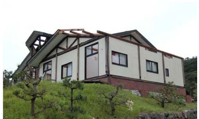
写真 4. 3. 53 連続する宿泊室部分の屋根の飛散
