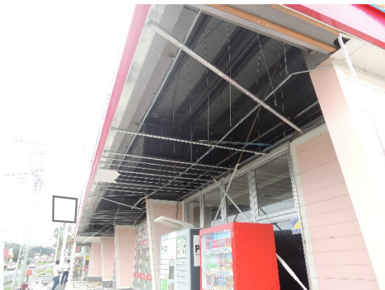
写真 4.1.3 軒天井の仕上げ材の脱落・飛散
