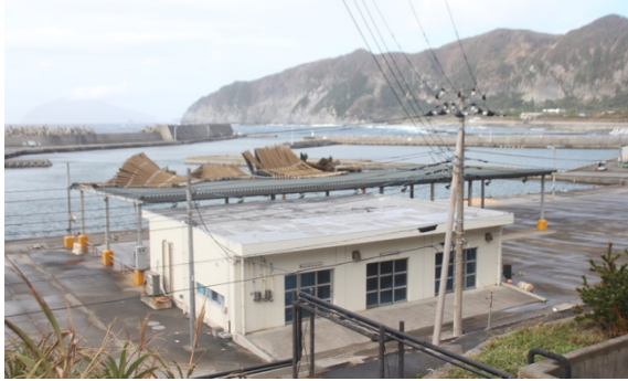
写真 5.2.30 漁港施設 A の屋根被害
