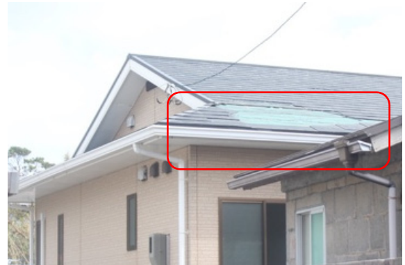
写真 5.2.13 住宅の屋根被害
