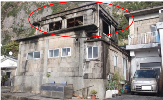
写真 5.2.34 住宅の屋根被害(1)
