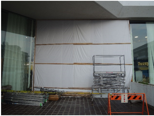
写真 3.2 第2庁舎南面入り口付近で破損したガラスの応急復旧状況(屋外側)
