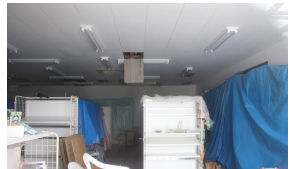
写真 5.1.26 屋根被害を受けた店舗 A の内部
