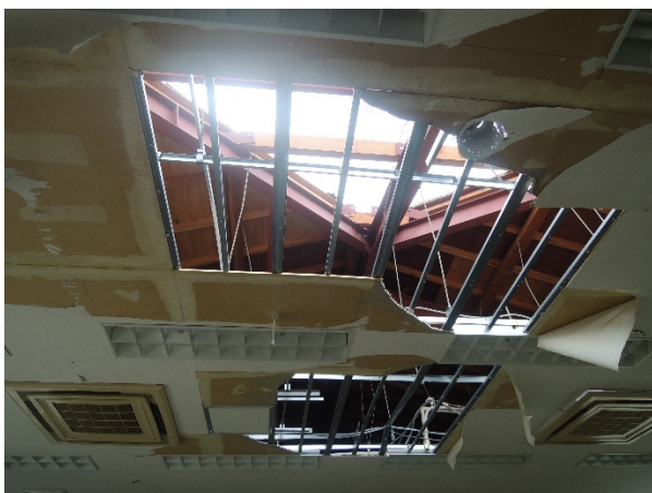
写真 4.1.18 2階天井と野地の被害状況
