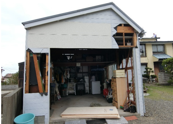
写真 4.3.37 外壁材が脱落した車庫
