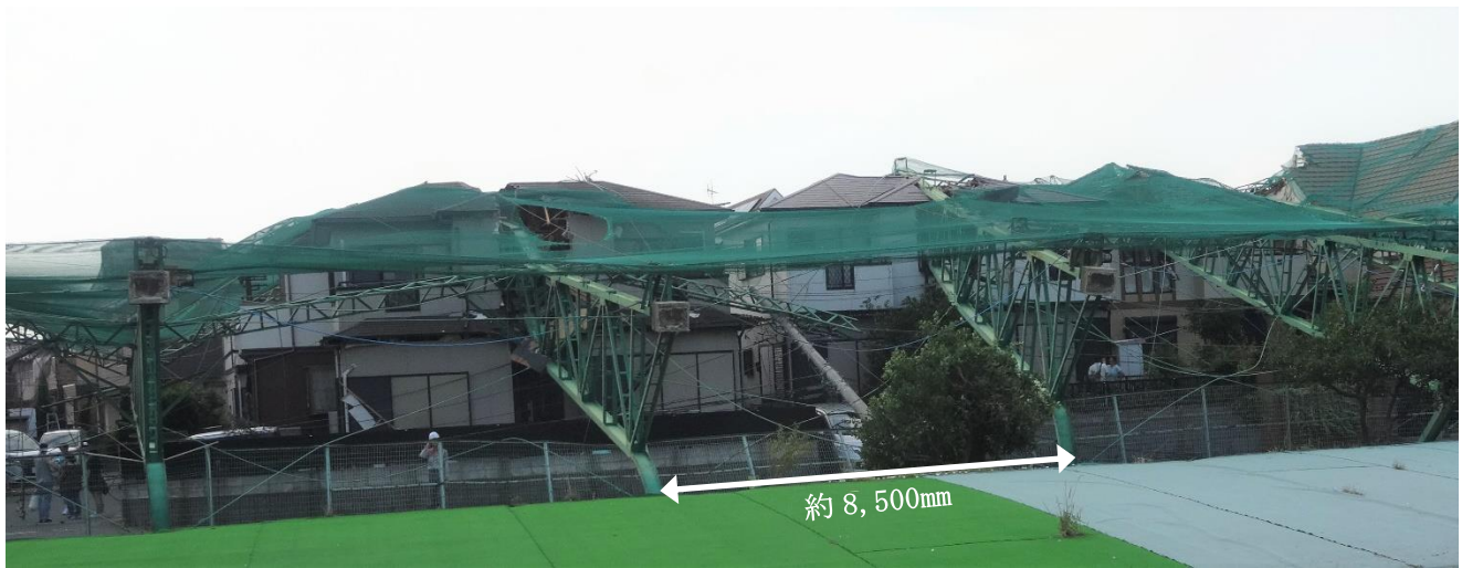
写真 3.1 鉄柱の倒壊状況
