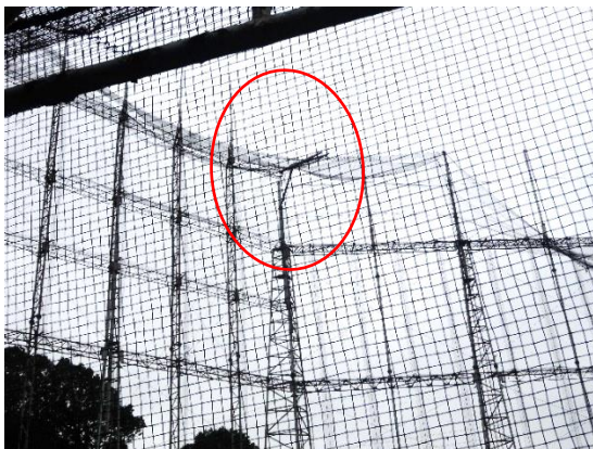
写真 3.30 先端部の被害状況(2)(南側)
