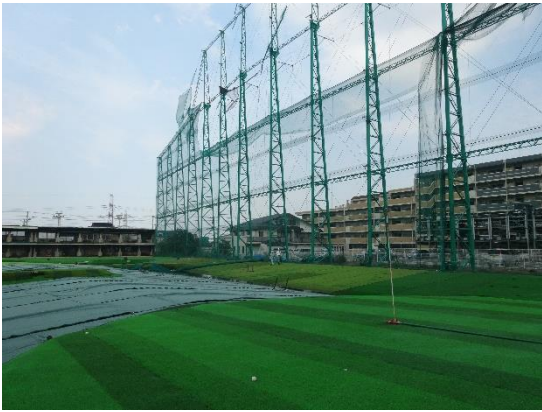
写真 3.10 敷地をはさんで倒壊した鉄柱の反対側にある鉄柱の状況
