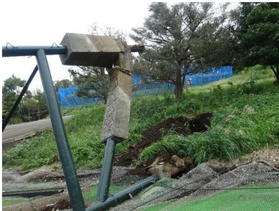
写真 3.26 写真 3.25 の引き抜け部分
