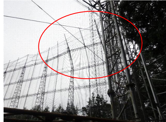
写真 3.29 先端部の被害状況(1)(北側)
