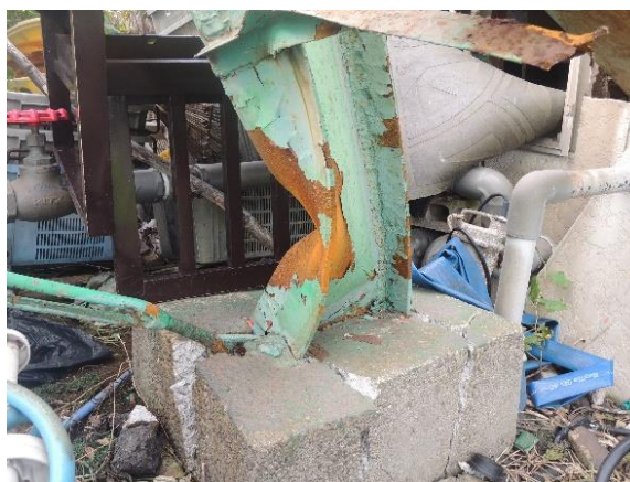
写真 3.5 鉄柱を構成するH形鋼の変形(1)
