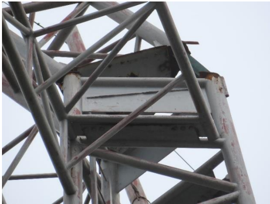
写真 3.34 被害部分の拡大写真(1) (北側の鉄柱)
