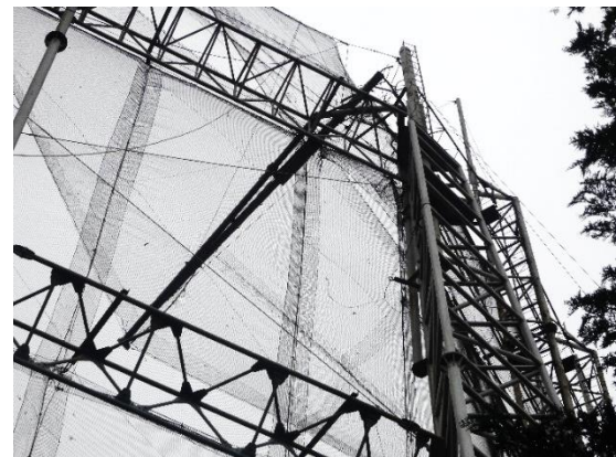
写真 3.31 折損した鉄柱(1)(南側の鉄柱)
