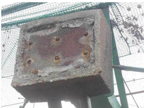
写真 3.4 柱脚アンカーボルトの破断(2)
