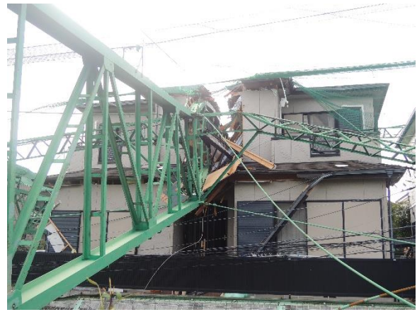
写真 3.11 近隣の住宅の被害(1)
