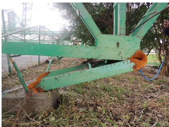
写真 3.6 鉄柱を構成するH形鋼の変形(2)
