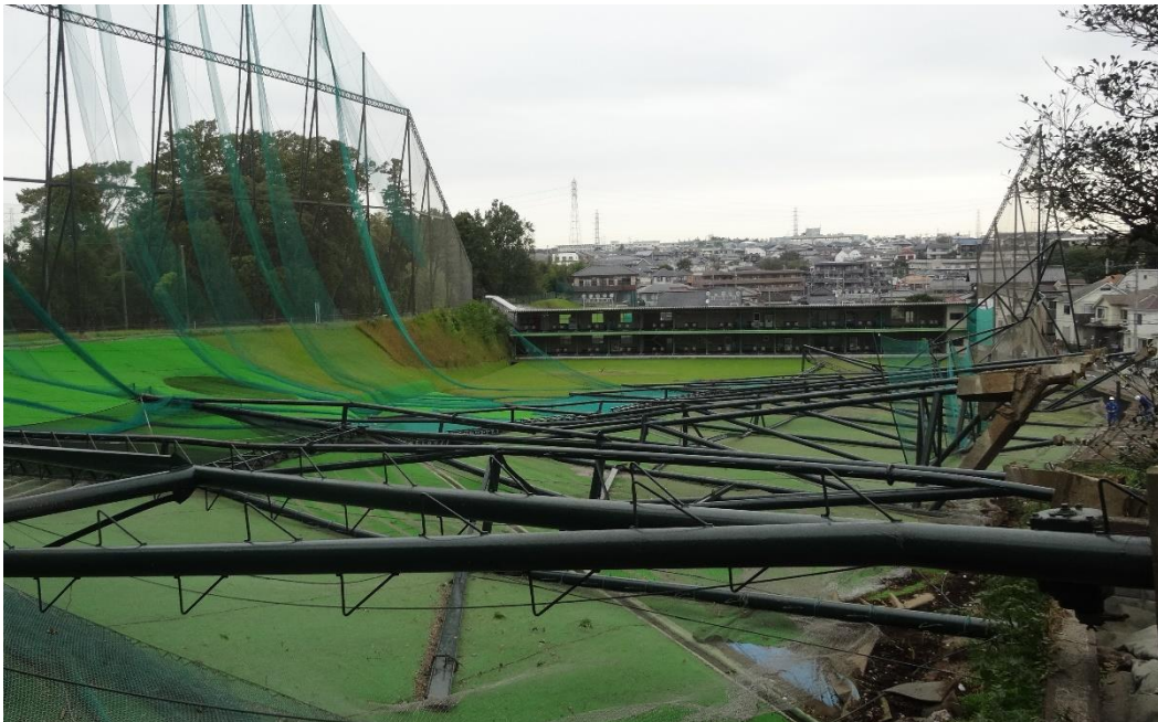
写真 3.15 鉄柱の倒壊状況(1)
