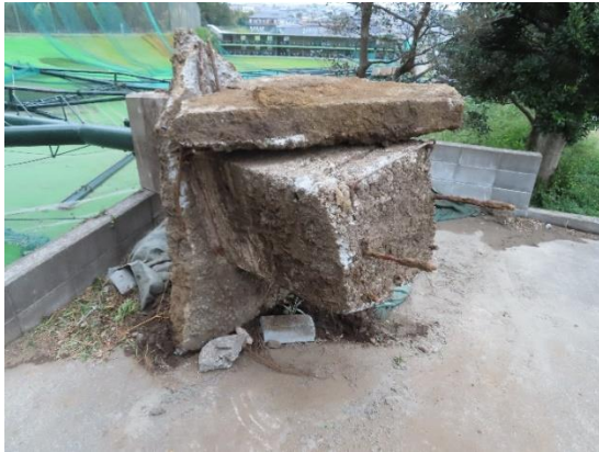
写真 3.24 引き抜けた柱脚(2)
