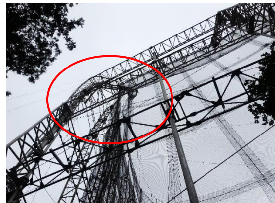
写真 3.33 先端部の変形(北側の鉄柱)
