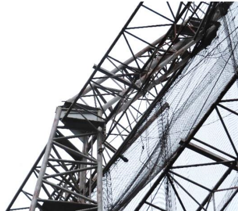
写真 3.35 被害部分の拡大写真(2) (北側の鉄柱)
