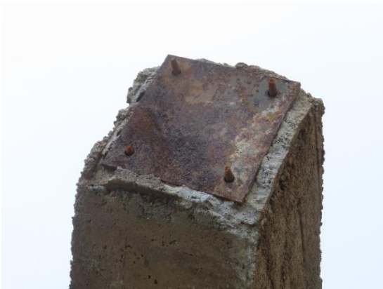
写真 3.18 ベースプレートとアンカーボルト(1)
