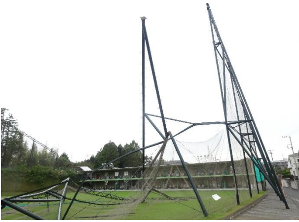
写真 3.16 鉄柱の倒壊状況(2)
