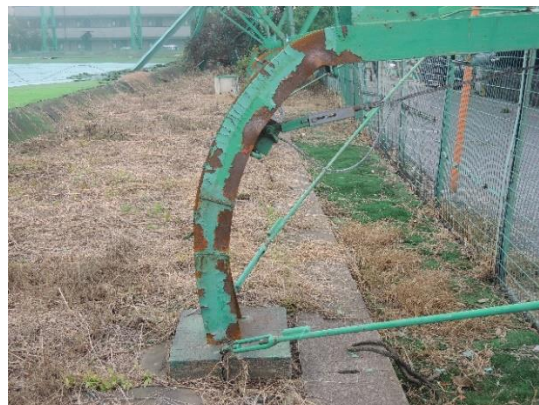
写真 3.7 鉄柱を構成するH形鋼の変形(3)
