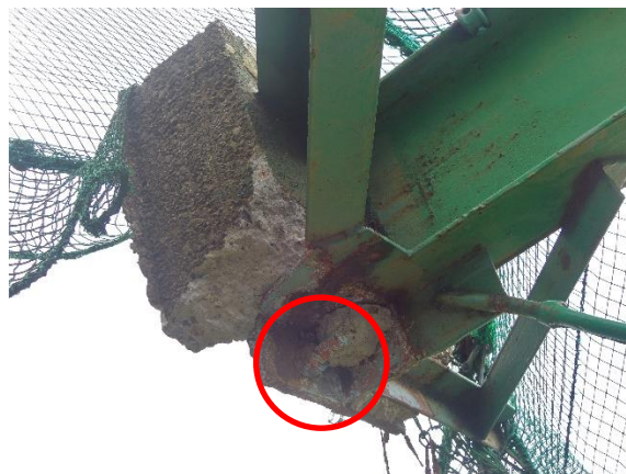
写真 3.3 柱脚アンカーボルトの破断(1)
