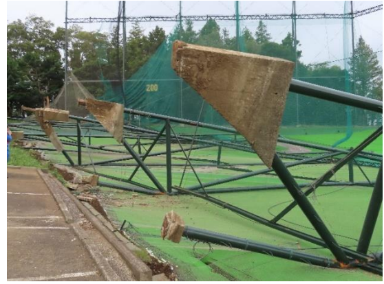
写真 3.23 引き抜けた柱脚(1)
