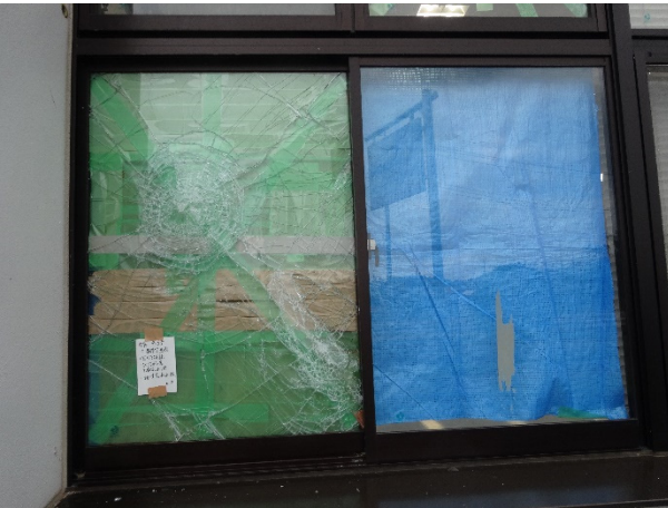
写真 3. 2. 15 窓ガラスの被害と養生状況
