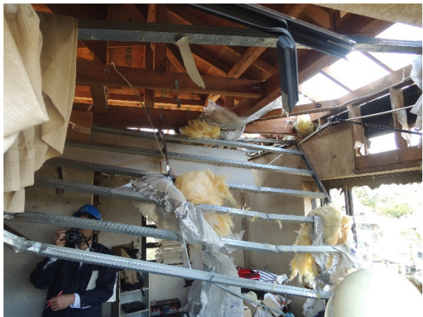
写真 3. 1. 45 天井材の落下
