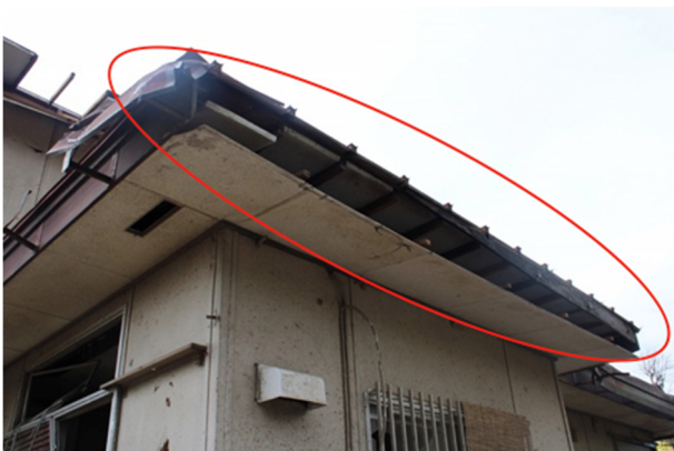
写真 3.1.5 屋根軒先部の損傷状況
