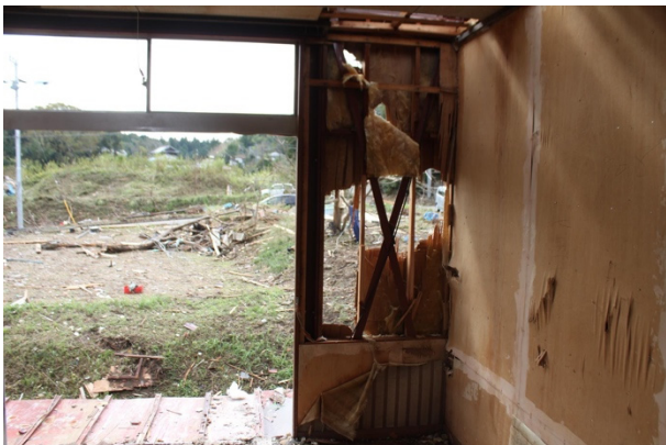
写真 3.1.3 窓ガラスや壁材が飛散した室内の様子
