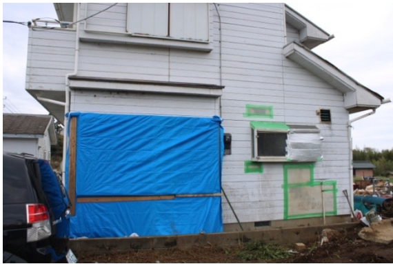
写真 3.1.23 東面の窓・壁の被害
