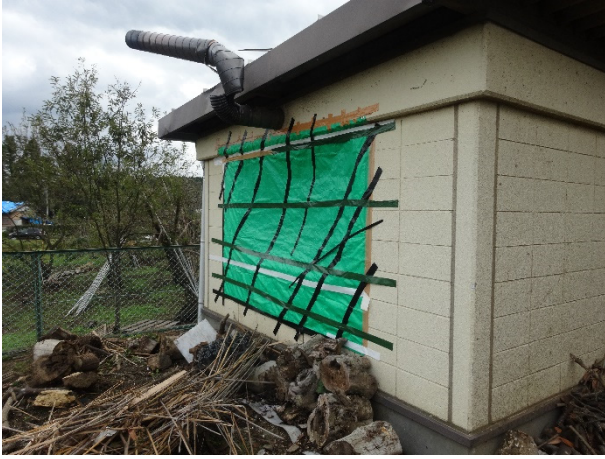
写真 3. 2. 9 陶芸室の窓ガラスの破損
