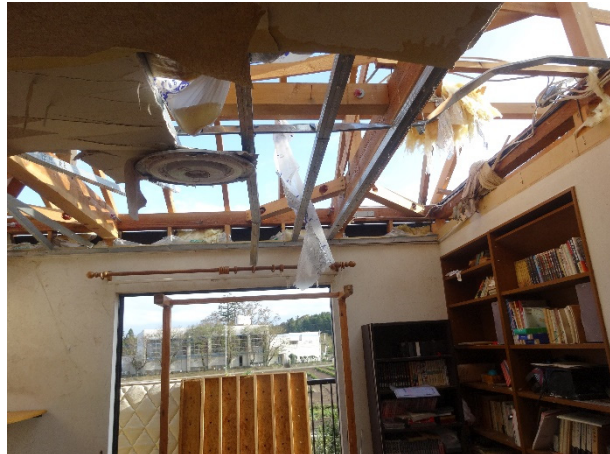
写真 3. 1. 46 野地板の飛散と天井材の破損
