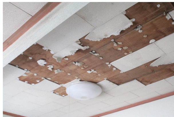
写真 3.1.18 天井の雨漏り被害
