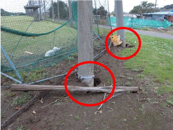
写真 3.3.20 支圧による柱のずれ
