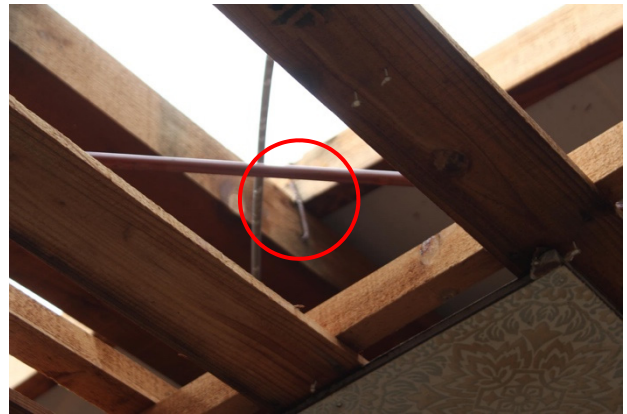
写真 3.1.8 小屋組のかすがい
