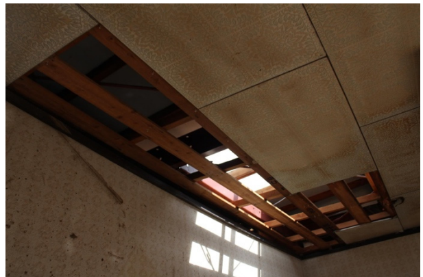
写真 3.1.4 天井材の損傷状況
