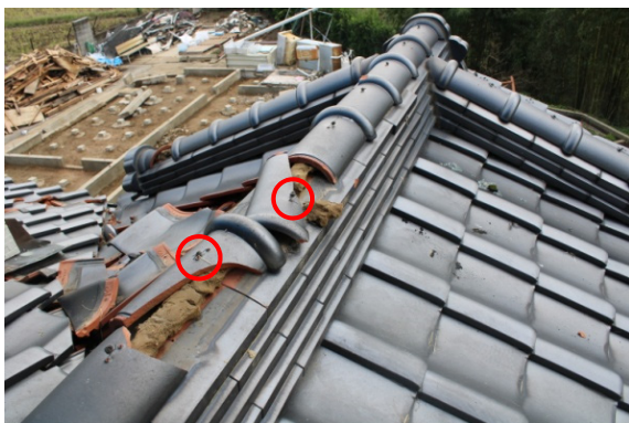
写真 3.1.27 棟瓦の割れ (赤丸部は銅線)
