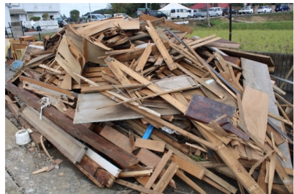
写真 3.1.32 敷地内の瓦礫
