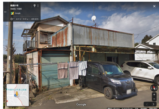
写真 3.1.22 倒壊した住宅 (Google ストリートビュー(2019年3月撮影)より)
