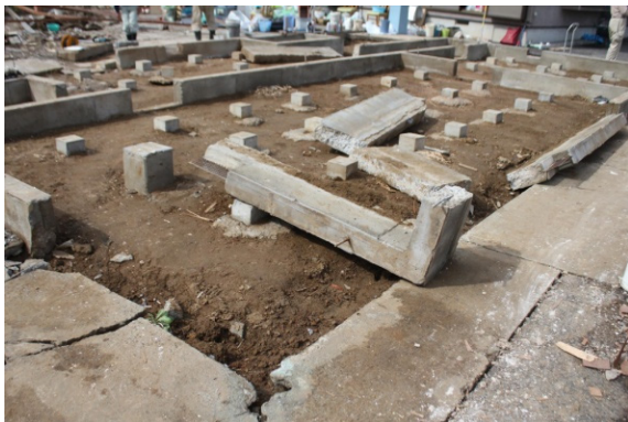
写真 3.1.31 残った無筋基礎 (南東側で折損)
