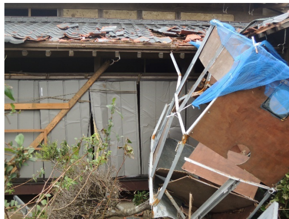
写真 3.1.14 農業用工作物の雨戸への衝突状況
