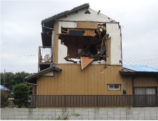
写真 3.1.56 北東側の外壁の損壊状況
