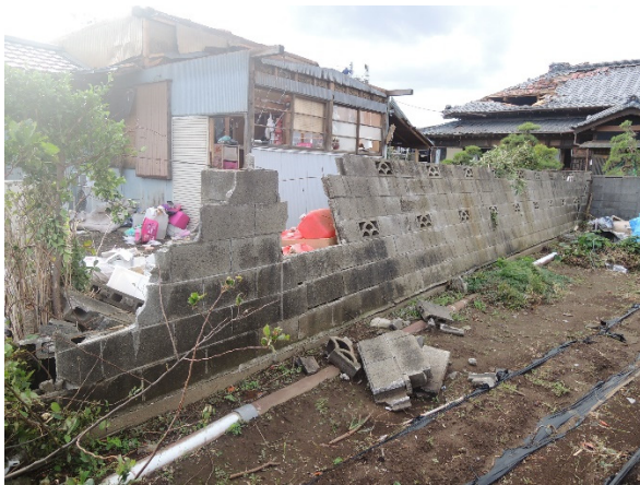
写真 3.3.12 ブロック塀の被害(1)
