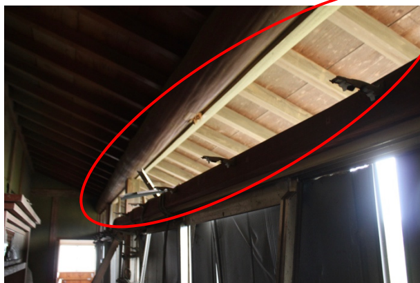
写真 3.1.15 脱落した欄間
