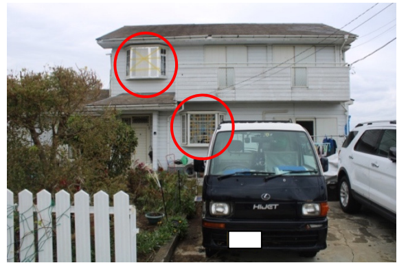
写真 3.1.24 南面の窓の被害
