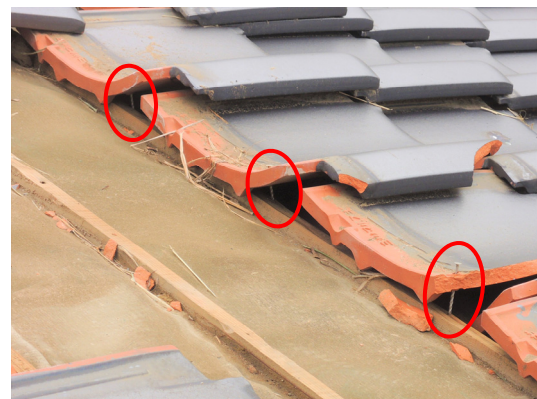
写真 3.1.28 釘打ちされた瓦
