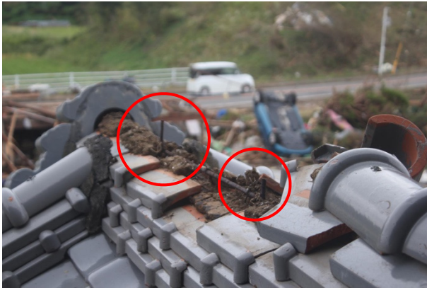
写真 3.1.19 鉄筋で留め付けられた棟瓦
