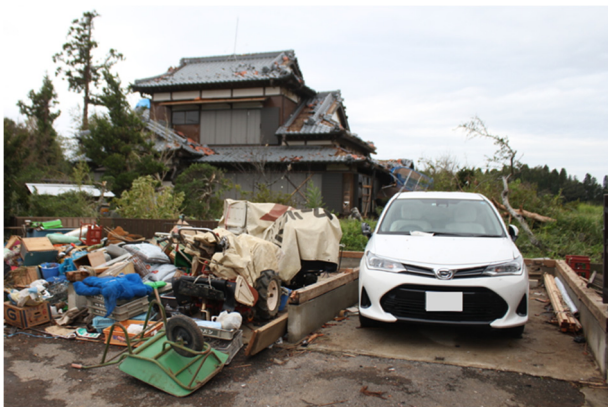
写真 3.3.5 倒壊した車庫 B
