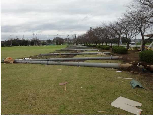
写真 3.3.18 コンクリート柱の倒壊状況
