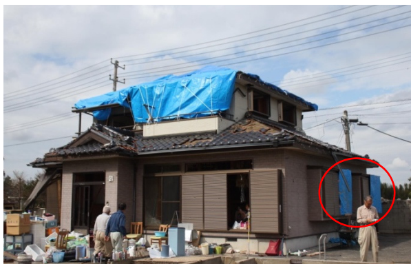
写真 3.1.25 南東側から見た雨戸、瓦の被害
