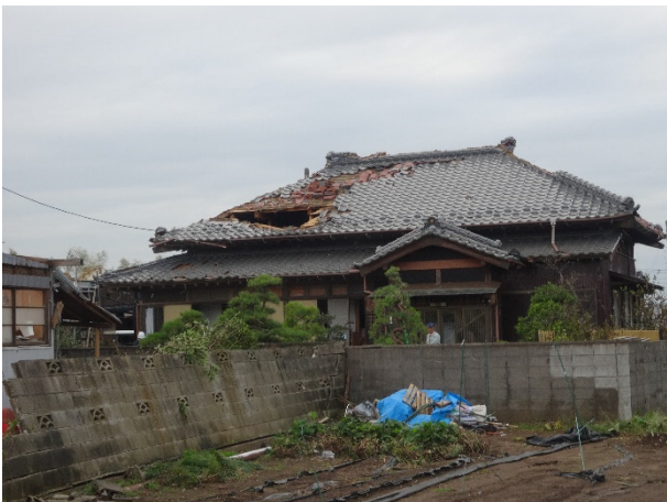
写真 3. 1. 48 住宅 K の屋根の状況 (南東側)
