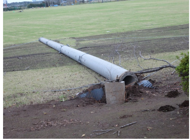
写真 3.3.19 柱の折損状況
