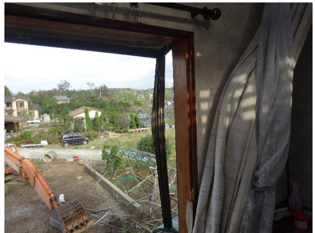
写真 3. 1. 36 サッシの変形
