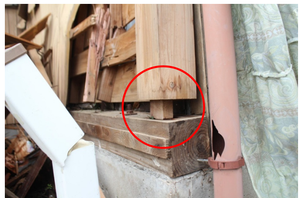
写真 3.1.12 抜け出した柱のほぞ
