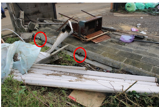
写真 3.3.14 ブロック塀の被害(3) (丸囲みは縦筋)
