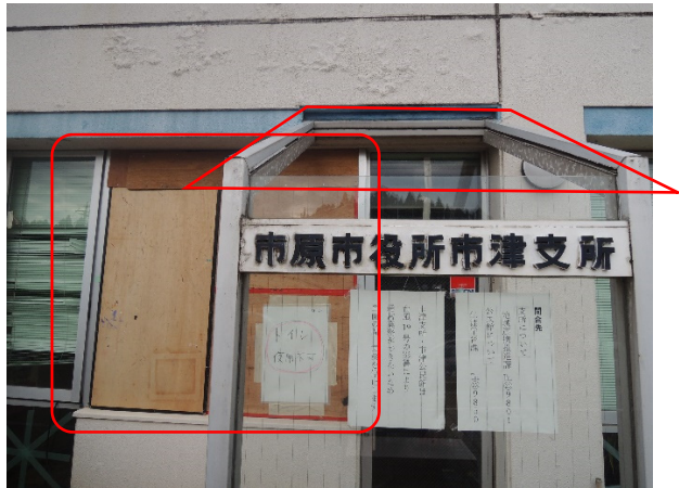
写真 3. 2. 11 市津支所の屋外に面するガラスの破損
