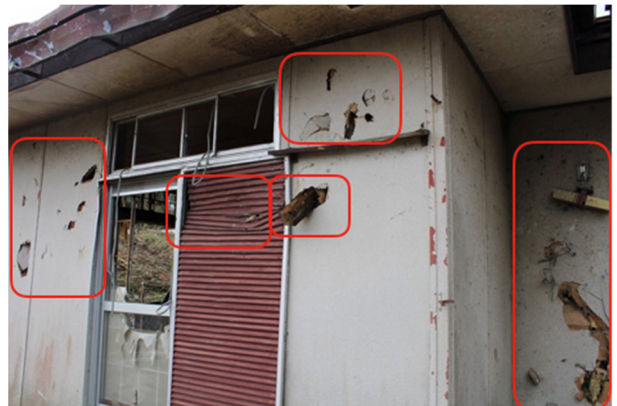
写真 3.1.6 飛来物の衝突や貫通 (東面 1F)
