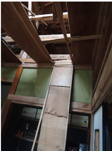
写真 3. 1. 54 室内側の被害(2)
