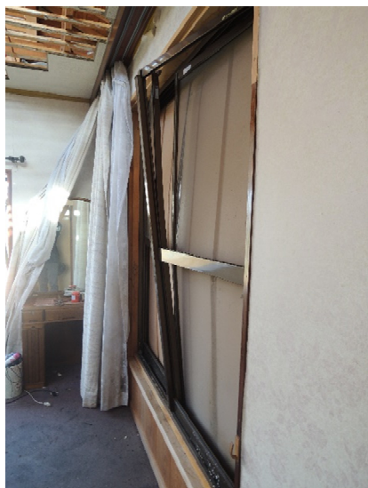
写真 3. 1. 37 室内側に変形した雨戸とサッシ
