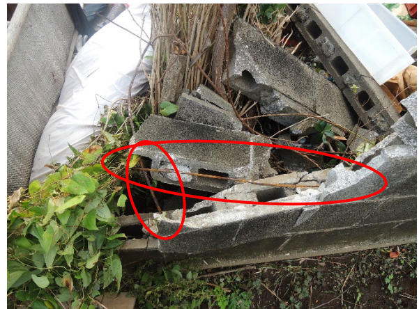
写真 3.3.13 ブロック塀の被害(2) (丸囲みは縦筋と横筋)
