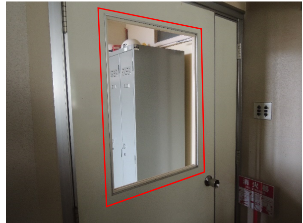
写真 3. 2. 12 市津支所内部のドアにはめ込まれたガラスの破損箇所
