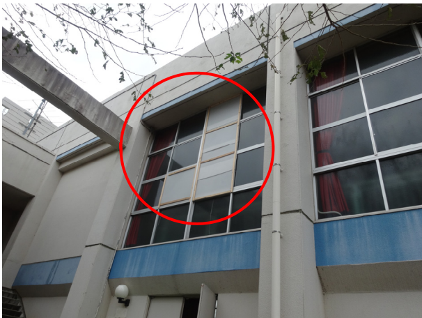
写真 3.2.7 体育室の破損した窓ガラス
