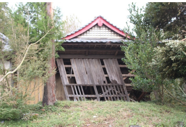
写真 3. 3. 1 本殿の被害状況
