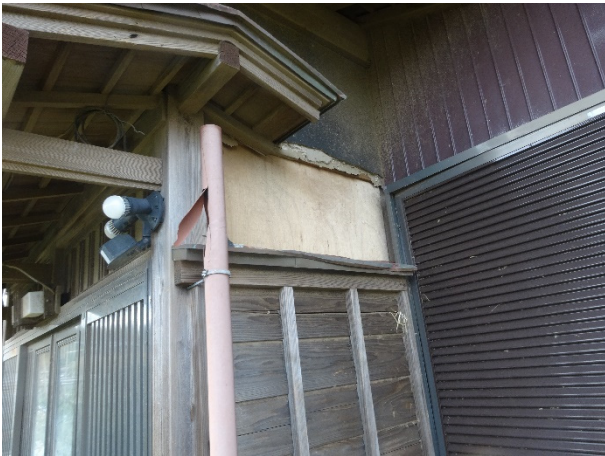
写真 3. 1. 52 玄関脇の被害
