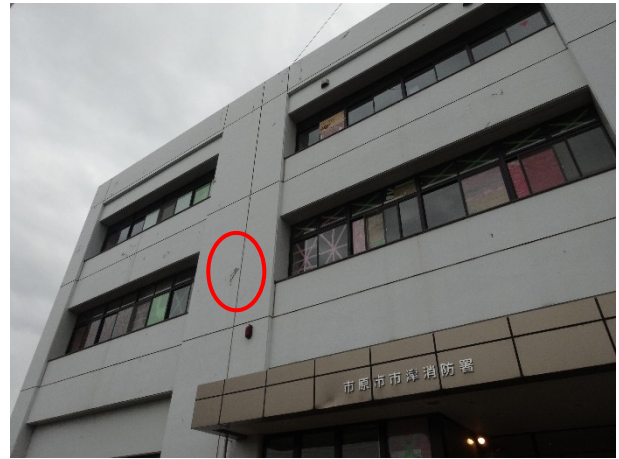
写真 3. 2. 14 外壁や窓ガラスの被害
