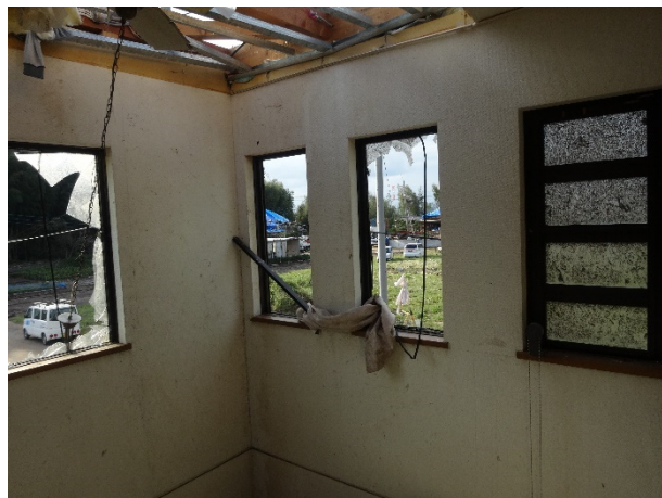
写真 3. 1. 44 吹き抜けでのガラスの破損
