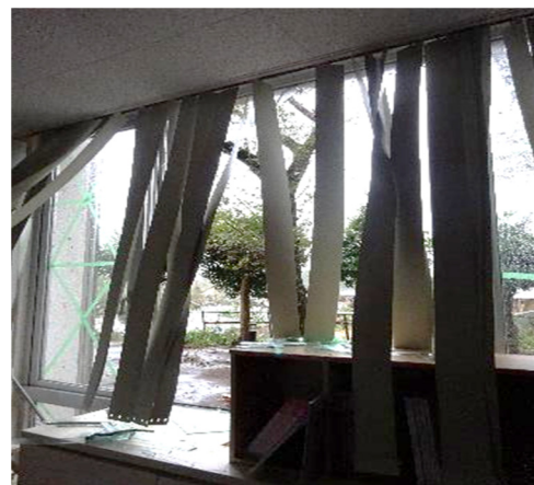
写真 3.2.2 図書室で破損した窓ガラスの状況 (市原市立市津公民館提供)
