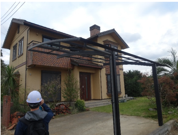
写真 3.3.22 カーポートの被害
