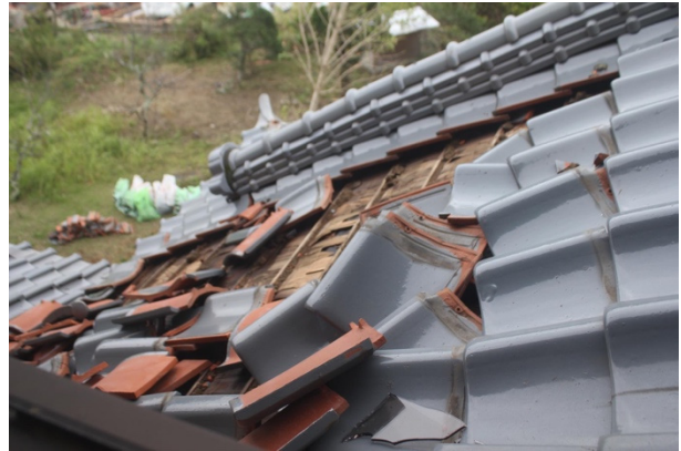
写真 3.1.20 屋根瓦の脱落
