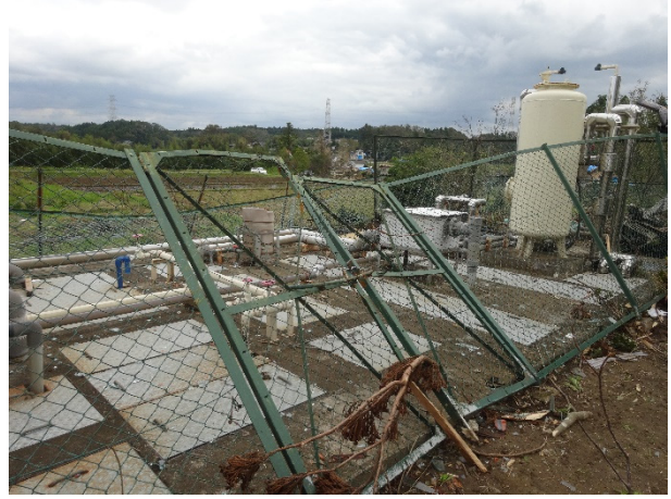
写真 3. 2. 10 フェンスの倒壊
