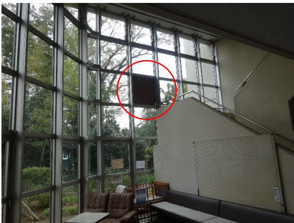
写真 3.2.1 破損した窓ガラスの状況
