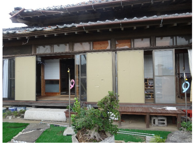
写真 3. 1. 51 住宅 K の壁面の被害（南東側）
