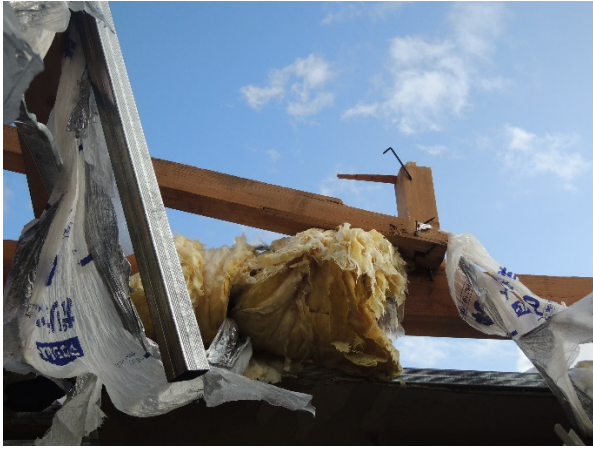
写真 3. 1. 47 小屋束の状況
