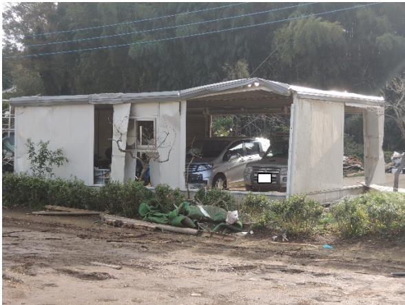
写真 3.3.8 車庫 C の損傷状況
