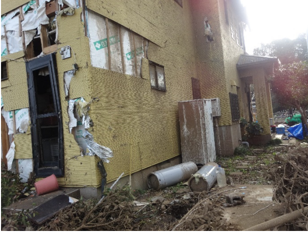
写真 3. 1. 41 外壁材の剥離(北側)
