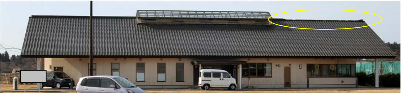
写真 2.8.9 南側の施設建築物の棟瓦の脱落
