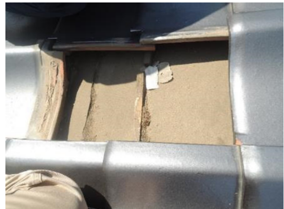
写真 2.4.4 付属の平屋での下葺材と瓦棧の状況 (棧瓦を一部撤去している)
