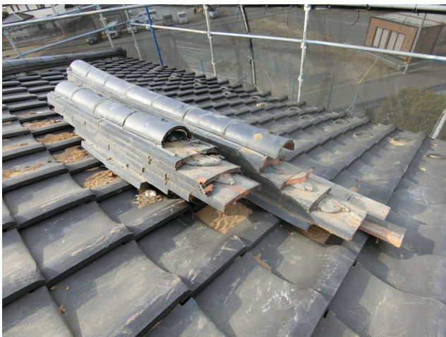
写真 2.7.3 脱落した大棟部
