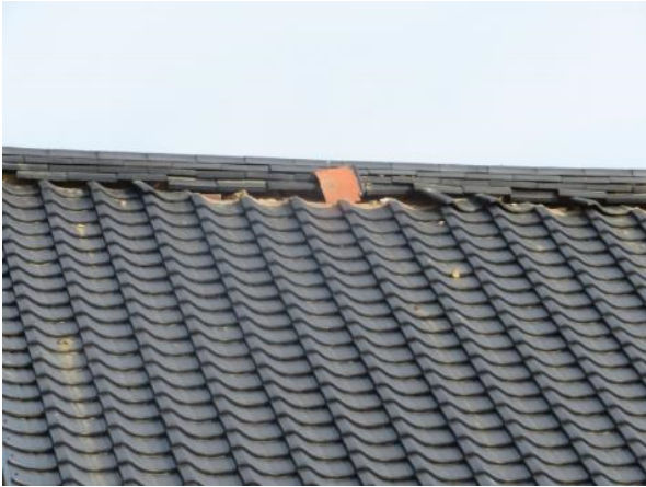
写真 2.8.3 東側棟の半端瓦の脱落
