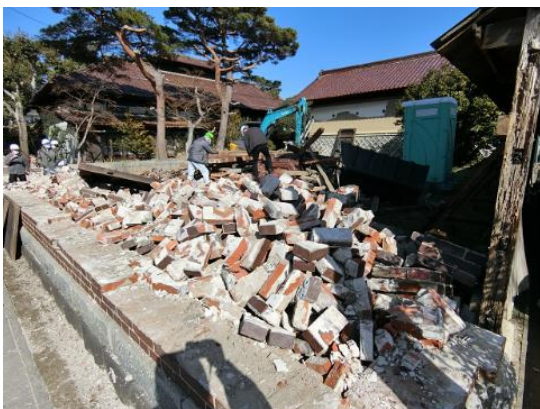
写真 3.2.1 崩壊した煉瓦による組積造の塀
