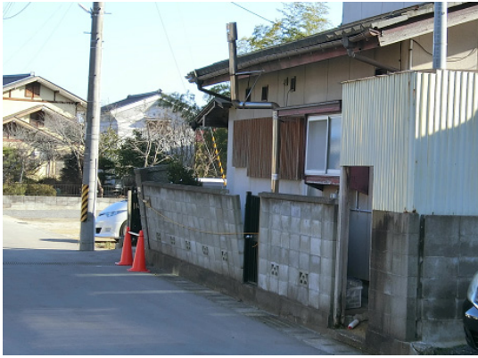
写真 3.2.3 大きく傾いたブロック塀
