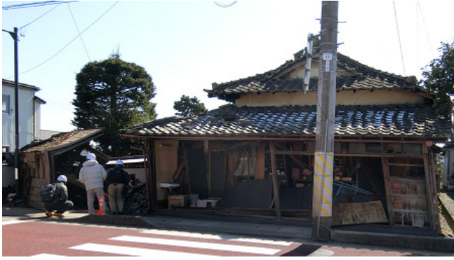
写真 3.1.1 大きな残留変形のある木造住宅
