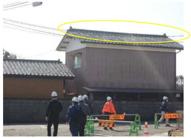
写真 2.9.10 過去の震災後に棟部の改修がされた可能性がある屋根
