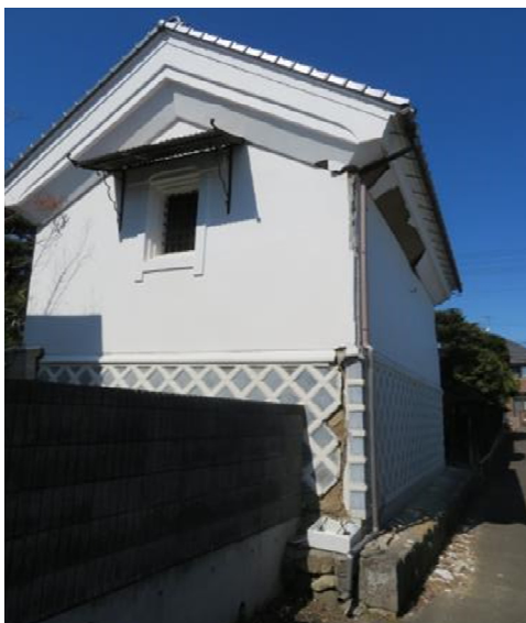
写真 3.1.5 外壁の漆喰壁に割れが生じた土蔵
