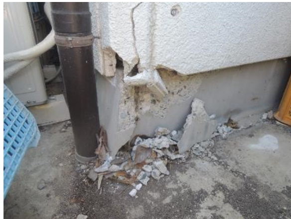
写真 2.1.6 基礎の隅角部の被害
