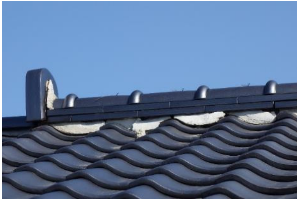
写真 2. 2. 3 棟の面戸漆喰の剥がれ
