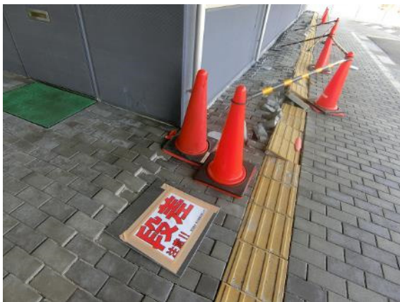
写真 3.3.2 公共施設での敷地地盤の変状
