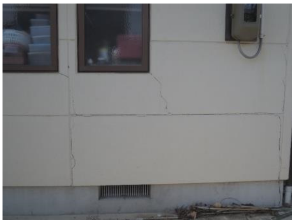
写真 2.1.7 物置と同敷地内にある居宅の外壁のひび割れ
