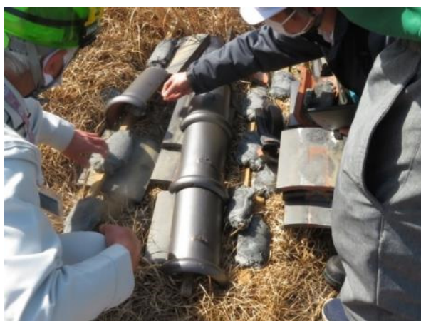
写真 2.9.5 脱落した棟部
