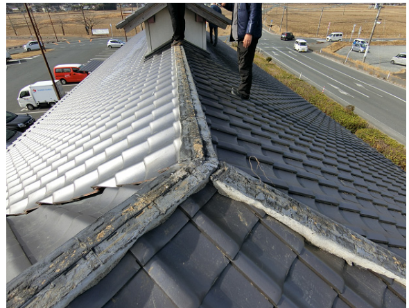
写真 2.8.6 西側棟の棟瓦と隅瓦の脱落
