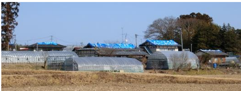
写真 2.9.8 散見された屋根瓦の被害
