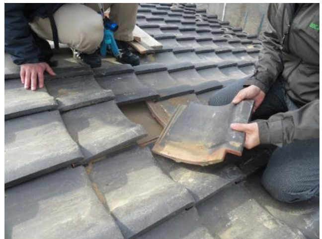
写真 2.7.2 釘留めされていない平部の瓦
