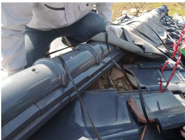
写真 2.1.3 隅棟部の状況
