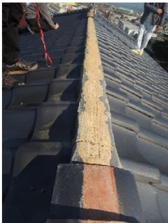
写真 2.5.3 のし瓦等が脱落した範囲の状況
