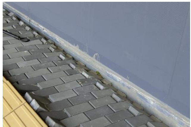
写真 3.3.3 噴砂の可能性を示唆する痕跡
