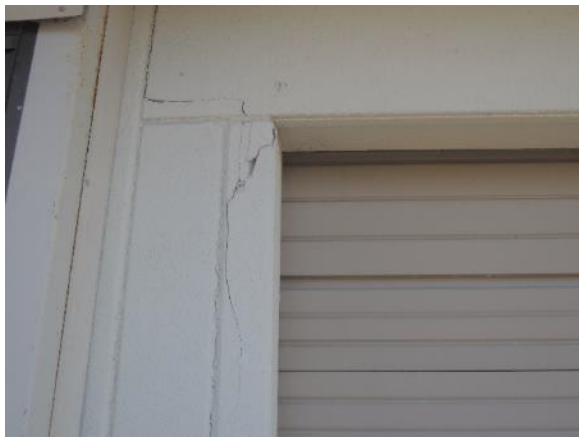
写真 2.1.5 開口の隅角部のひび割れ
