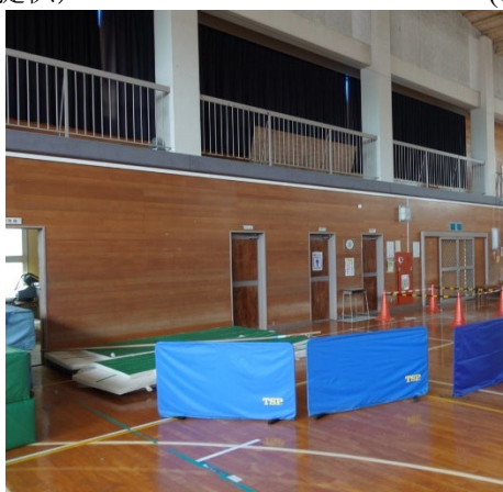
(c) 東面における立ち入り禁止範囲 (暗幕の部分が破損した 2 階窓)
