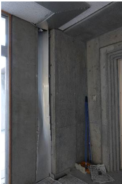
図 4.1.2 (q) エクスパンションジョイントの損傷
