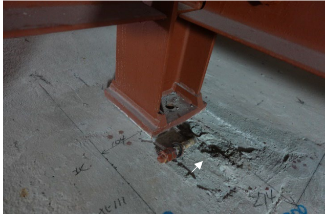
(b) ボルトの破断と柱脚の移動
