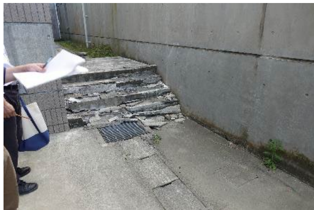
図 4.1.2 (t) 外階段の損傷
