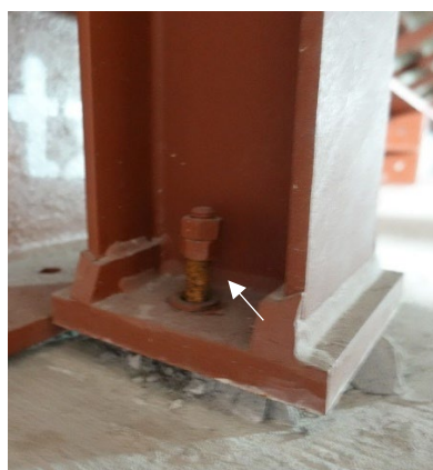
(b) モルタルの破損とボルトの抜け出し
