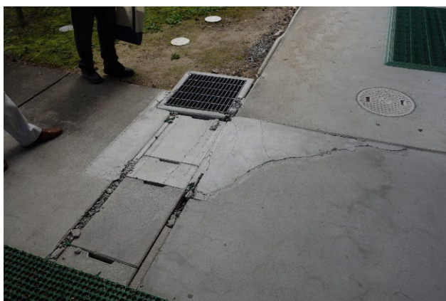
図 4.1.2 (u) 地盤沈下に伴う床のひび割れ
