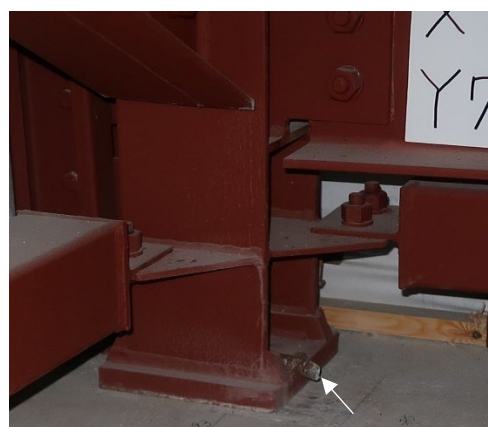
(b) 左図の拡大図（ボルトが破断している）
