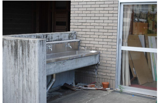
図 4.1.2 (e) 水飲み場と非構造壁の接続部のひび割れ
