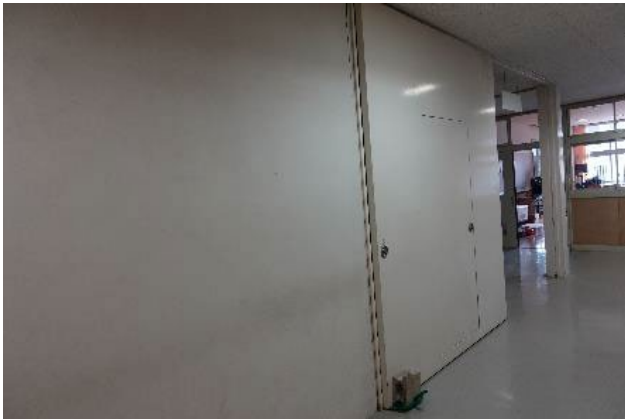
図 4.1.2 (o) 防火扉の損傷
