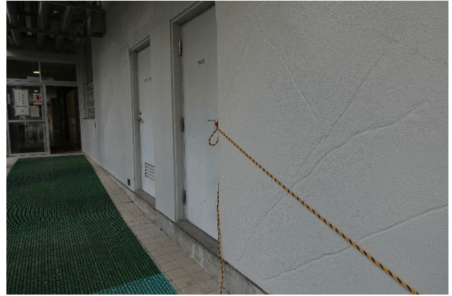
図 4.1.2 (n) 機械室ドアの損傷
