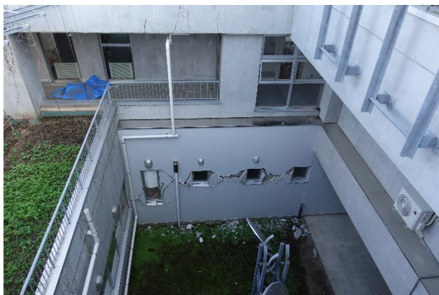
図 4.1.2 (a) 非構造壁のせん断破壊
