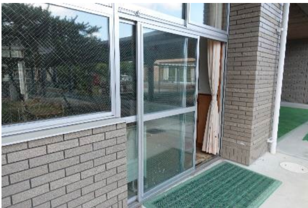
図 4.1.2 (i) 扉の鍵部の変形
