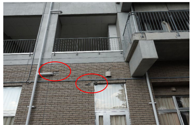
図 4.1.2 (l) タイルの剥落
