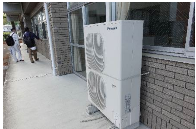
図 4.1.2 (j) 室外機の転倒防止金具
