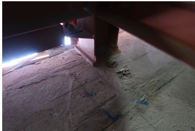
(c) 端部における柱脚のずれ
