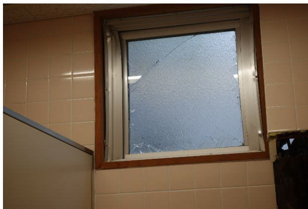
図 4.1.2 (b) トイレの窓の損傷
