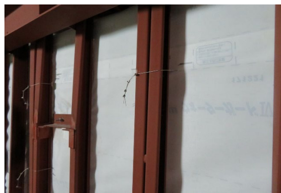
(c) 外装材の落下防止のためのワイヤー
