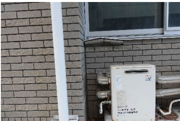
図 4.1.2 (k) タイルの浮き
