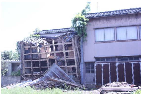
写真 6.5.1 増設した納屋の外壁の崩落
