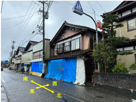
写真 6.1.3 周辺で残留変形の大きい店舗併用住宅
