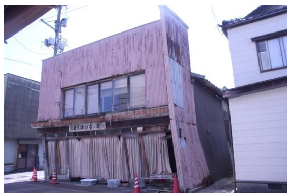
写真 6.5.4 店舗併用住宅の傾斜
