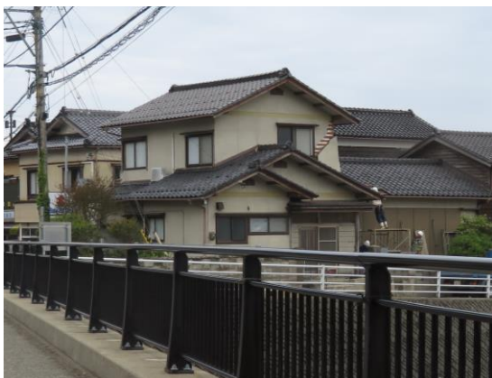
写真 7.4.5 外壁に割れが生じた住宅
