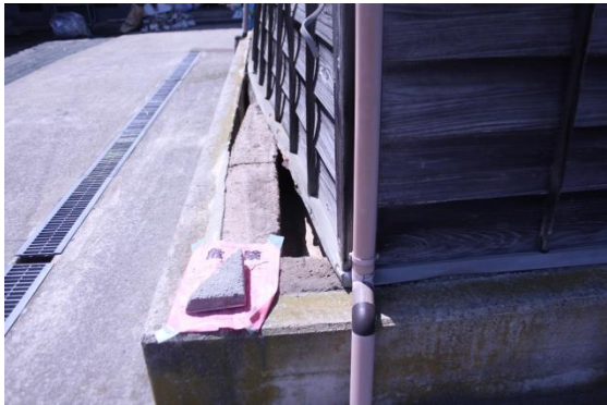
写真 6.2.22 基礎から大きくずれた納屋
