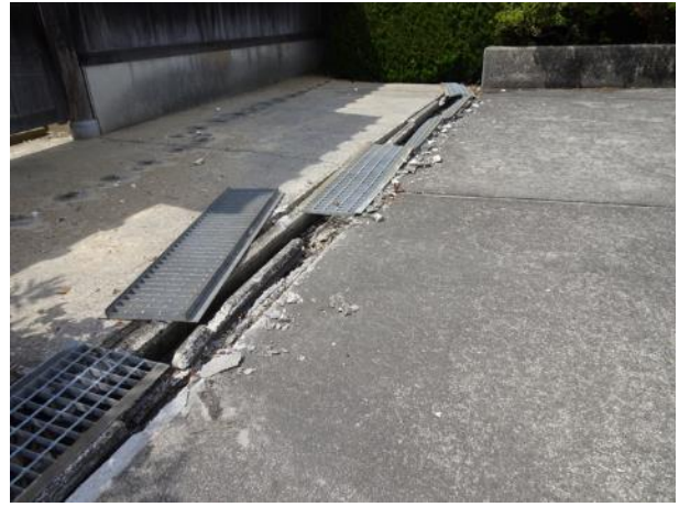
写真 8.4.6 住宅 B の側溝の被害
