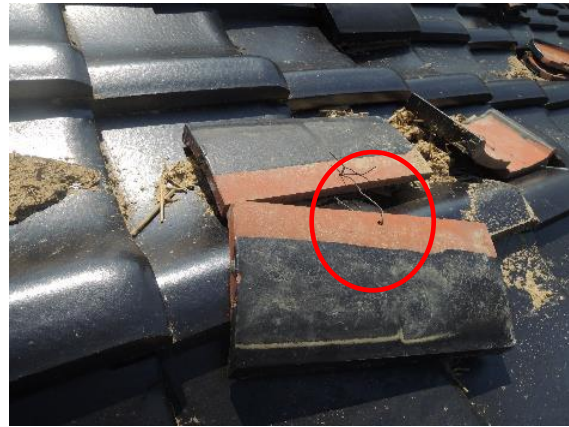
写真 8.2.8 脱落したのし瓦(2)
