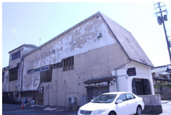
写真 6.5.2 店舗の外装材の崩落
