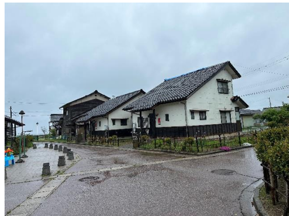
写真 6.2.8 屋根瓦に被害を受けた公営住宅
