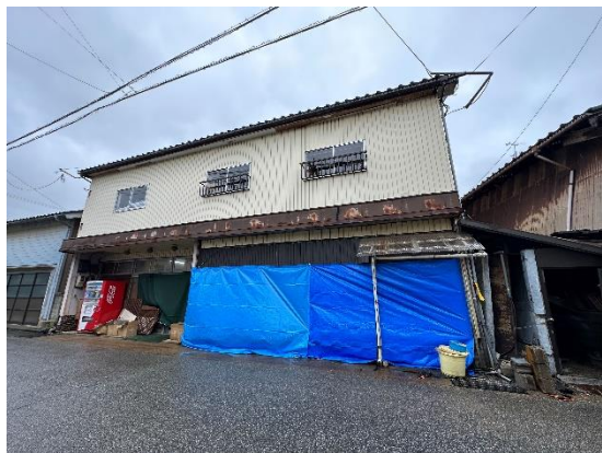
写真 6.2.2 写真 6.2.1 北隣の傾いた店舗併用住宅
