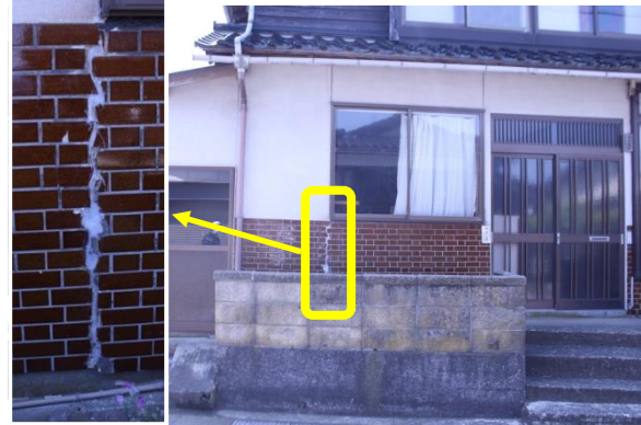
写真 6.4.2 住宅の開口隅の亀裂と応急的な補修
