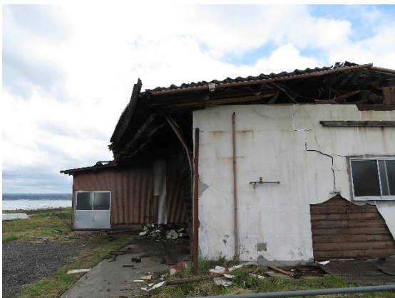
写真 6.2.18 写真 6.2.16 の倉庫の倒壊した小屋組
