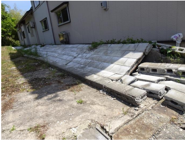
写真 8.6.9 ブロック塀の被害 3 (珠洲市正院町正院)
