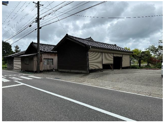
写真 6.3.2 写真 6.3.1 近傍の残留変形がある車庫
