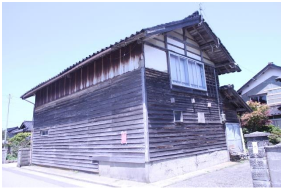
写真 6.2.20 傾斜した住宅
