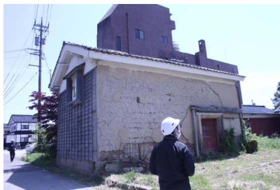
写真 6.4.4 納屋の外壁の剥落
