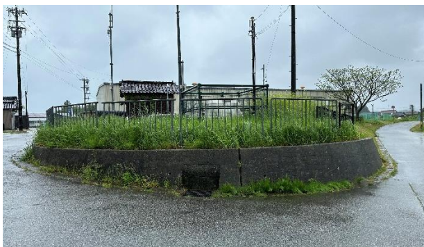
写真 7.1.1 地震計設置状況
