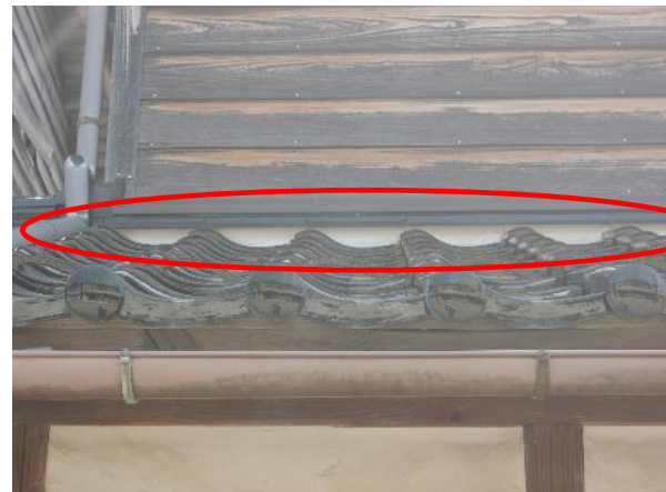
写真 8.1.2 表面にモルタルが塗布されている面戸 瓦の例
