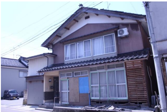
写真 6.4.3 住宅の外壁の剥落と開口の破損
