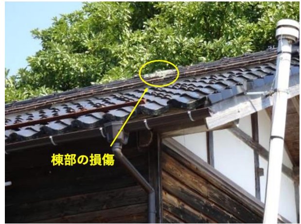
写真 8.5.2 棟部の被害 (珠洲市正院町正院)
