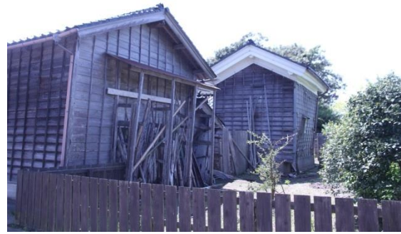
写真 6.2.21 傾斜した納屋
