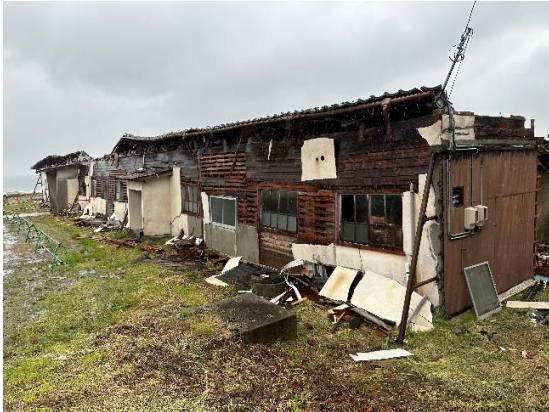
写真 6.2.16 屋根が崩壊した大規模倉庫
