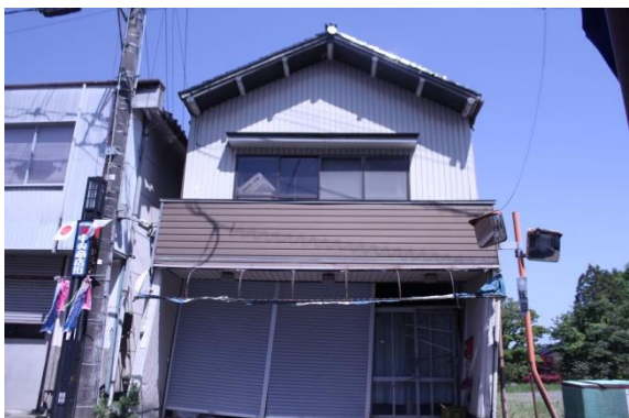
写真 6.5.3 店舗併用住宅の傾斜 1/10rad
