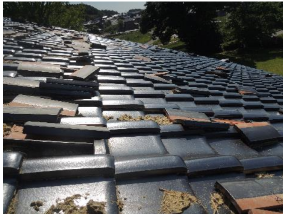
写真 8.2.7 脱落したのし瓦(1)
