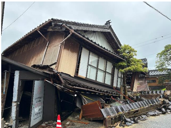
写真 6.2.1 正院町正院の倒壊住宅
