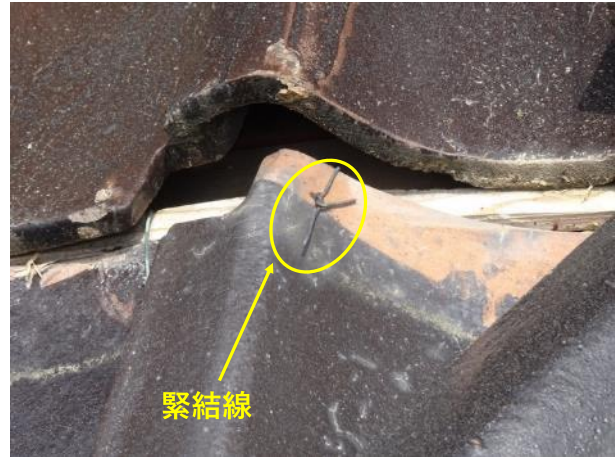
写真 8.5.8 倒壊した建築物の瓦の緊結状況 (珠洲市三崎町)
