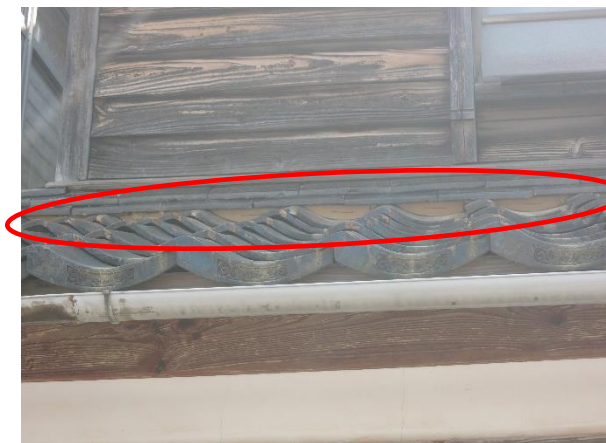
写真 8.1.1 表面にモルタルが塗布されていない 面戸瓦の例
