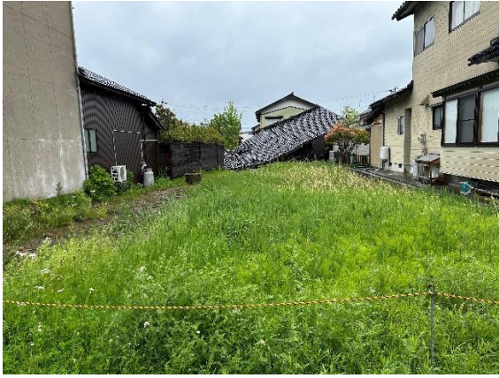
写真 6.2.3 写真 6.2.1 近傍の倒壊住宅 1
