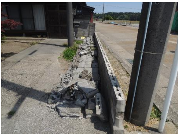
写真 8.6.7 ブロック塀の被害 1 (珠洲市正院町正院)
