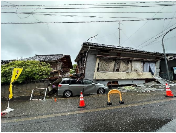
写真 6.1.1 倒壊した住宅全景
