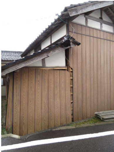
写真 6.2.11 外壁と下屋部分が外れかけた住宅
