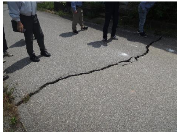
写真 8.6.10 アスファルト舗装の亀裂 (珠洲市正院町正院)
