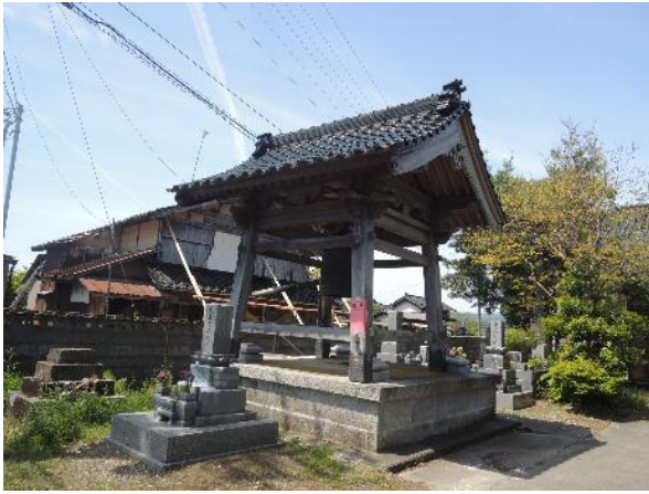
写真 8.6.3 鐘撞堂の被害 (珠洲市正院町正院)
