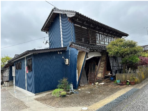
写真 6.2.7 残留変形の大きい住宅
