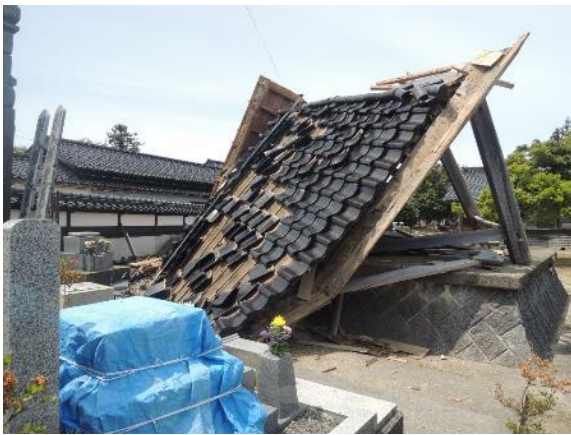
写真 8.6.5 鐘撞堂の被害 (珠洲市正院町正院)
