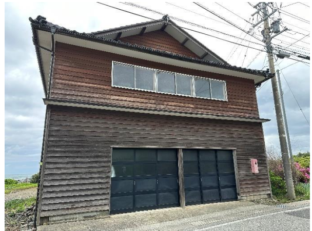
写真 7.2.2 残留変形のある倉庫
