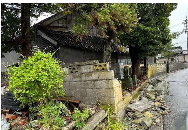
写真 7.1.3 ブロック塀の倒壊
