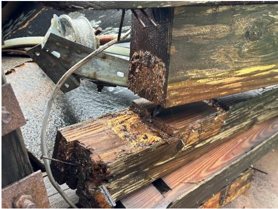
写真 6.2.5 写真 6.2.4 の住宅の腐朽・蟻害
