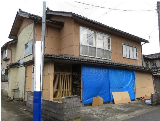
写真 6.2.13 隅柱が土台を踏み外した現代的な工法の住宅
