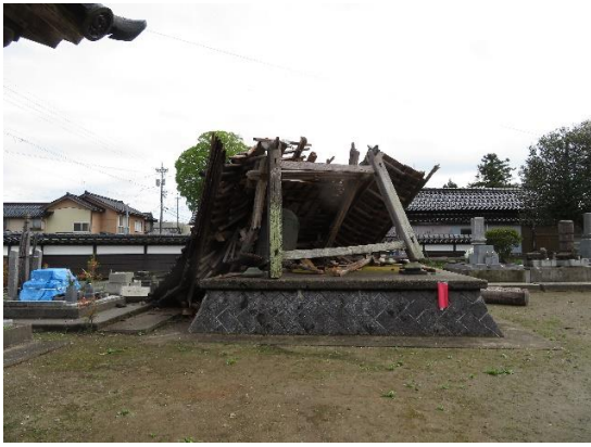
写真 6.2.15 倒壊した鐘楼
