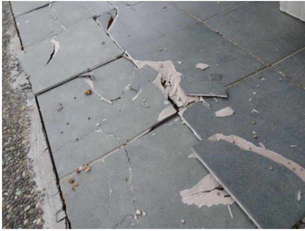
写真 8.4.5 玄関床部での被害
