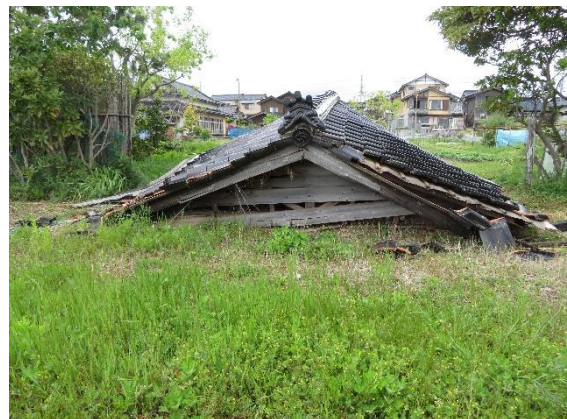
写真 6.2.19 写真 6.2.16 の倉庫の近くで倒壊していた小規模倉庫
