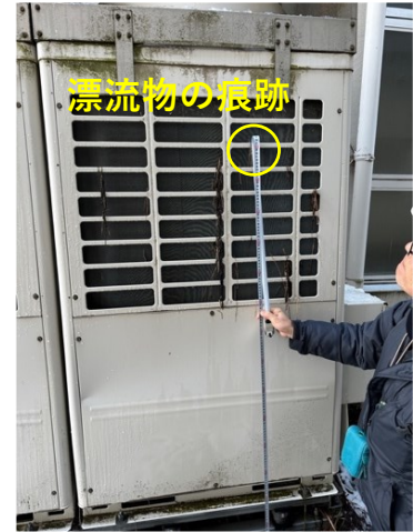
図 6.1.3 室外機に付着した漂流物の痕跡
