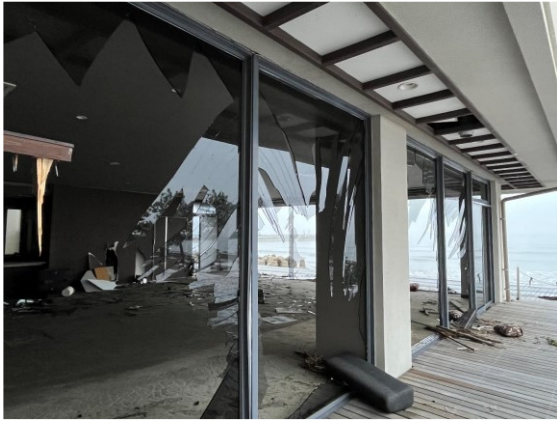
図 5.1.3 1階の窓ガラスの損傷(2)
