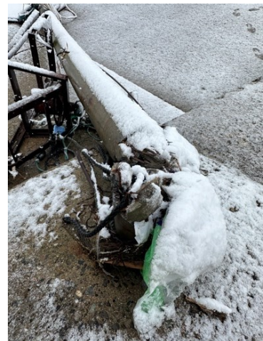
図 5.3.8 コンクリート柱の折損
