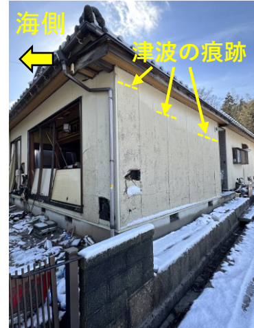
図 6.3.14 漂流物による外壁の被害と津波の痕跡
