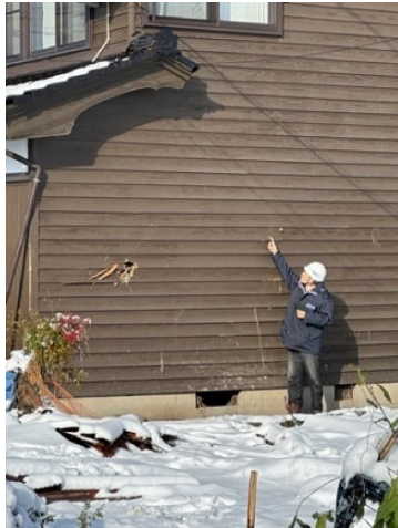
図 6.2.11 津波の漂流物の痕跡
