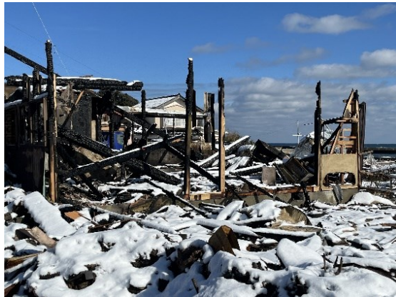
図 6.3.15 火災被害状況(1)
