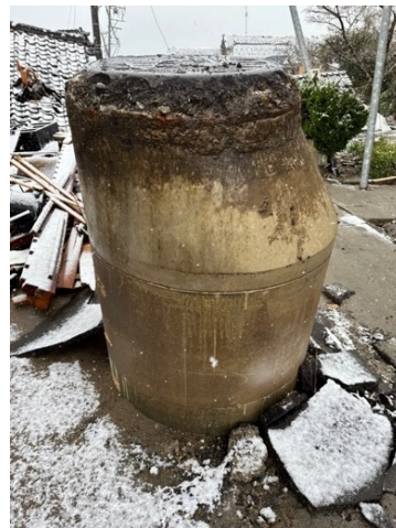
図 5.2.8 突出したマンホール
