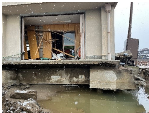
図 5.2.4 RC 造建築物周囲の地盤の洗掘
