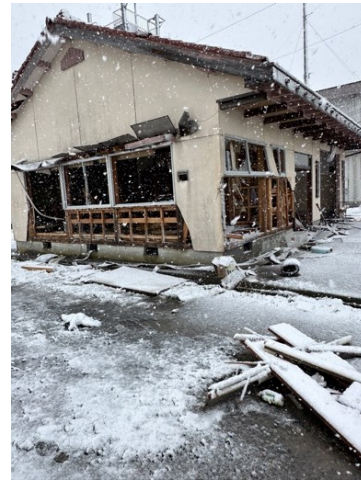
図 5.3.5 側面及び陸側の壁の損傷
