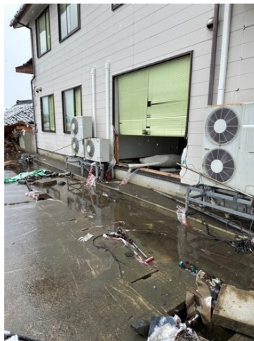
図 5.2.2 木造建築物の被害
