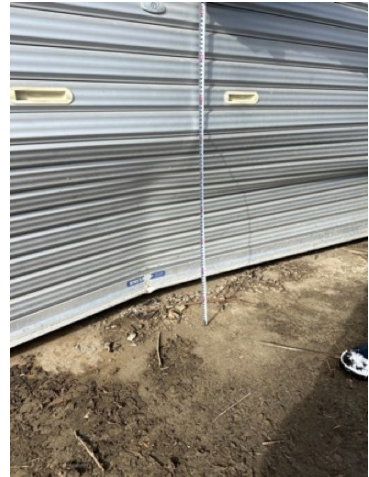
図 6.2.12 変形したシャッター
