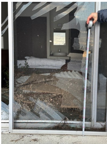
図 6.1.4 痕跡高さとガラスの被害
