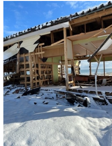
図 6.2.9 津波による背面の被害
