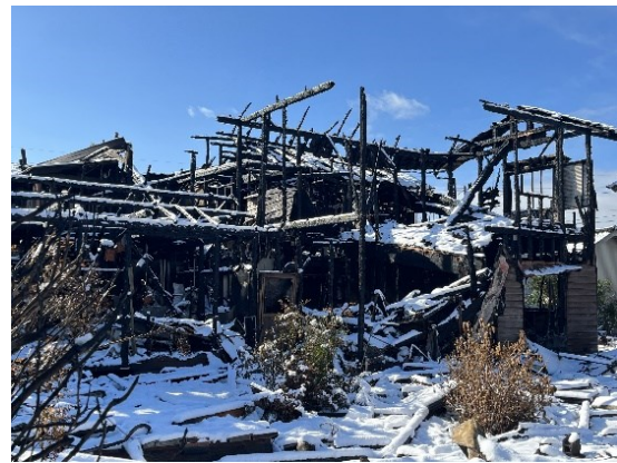
図 6.3.16 火災被害状況(2)
