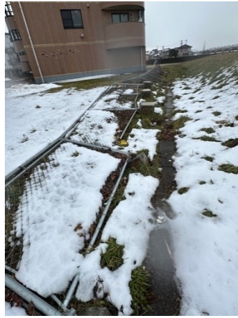
図 4.1.2 フェンスの倒壊
