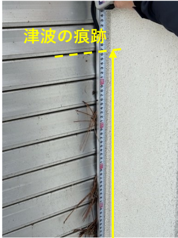
図 6.1.1 シャッターに付着した痕跡の高さ
