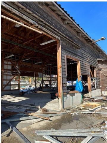
図 6.3.4 海側の開口部の損傷
