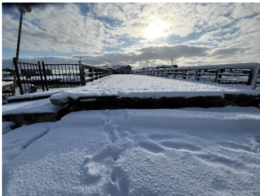
図 6.2.16 橋と道路との間の段差
