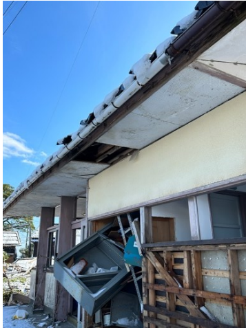
図 6.3.12 軒天井の損傷
