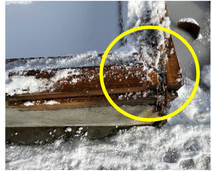
図 6.2.5 流失した住宅の土台隅角部の状況
