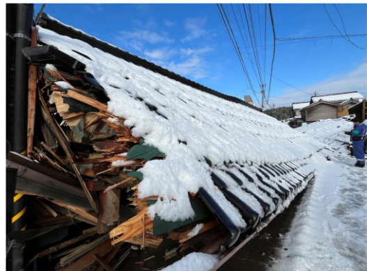
図 6.2.17 倒壊した建築物の瓦屋根
