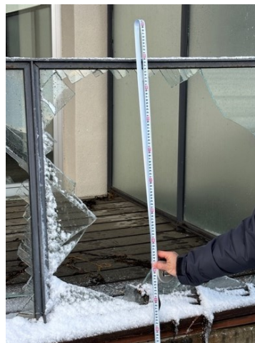
図 6.1.5 損傷したガラスの高さ
