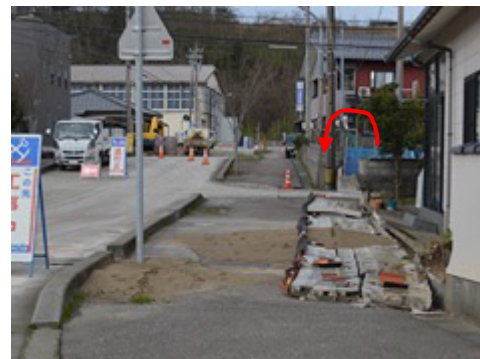
j) 擁壁の転倒
