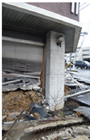
b) 南東隅柱
