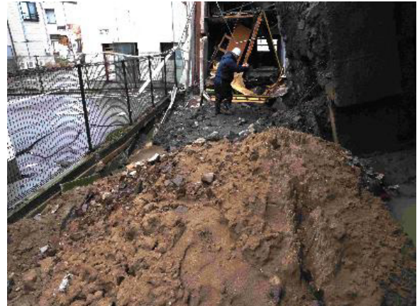
写真 6.6 地表面の変状（敷地の南側）
