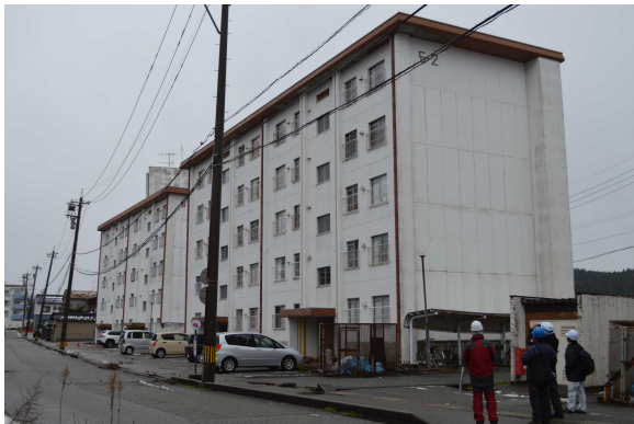
写真 9.1 川側（紙面の奥向き）に傾斜した壁式 RC 造の板状住宅（左側の建物）
