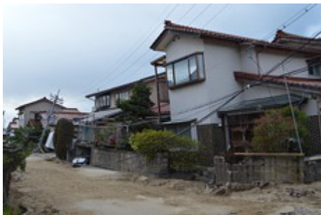
m) 住宅の沈下
