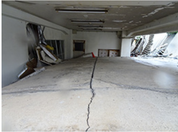
a) 床面の盛り上がり
