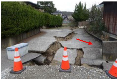
o) 側方流動した地盤と地割れ
