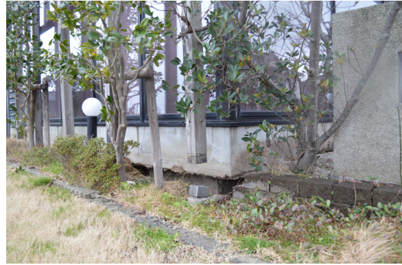
写真 10.2 E ホテル西館の周辺地盤の沈下
