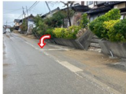
h) 傾斜した擁壁
