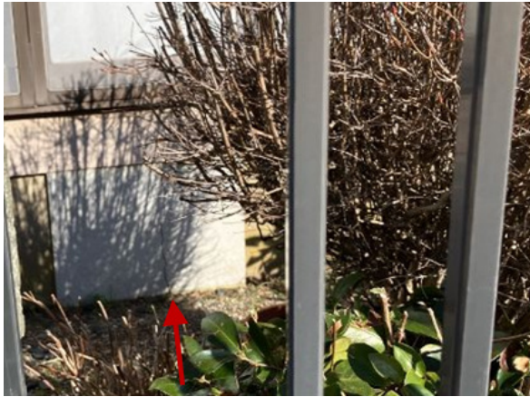
写真 4.3 住宅の基礎立ち上がり部のひび割れ
