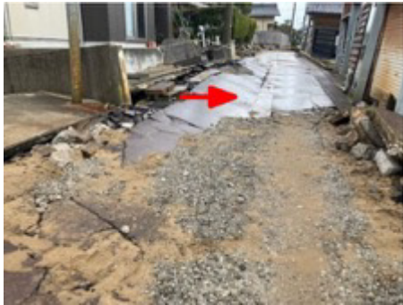
e) 側方流動した地盤
