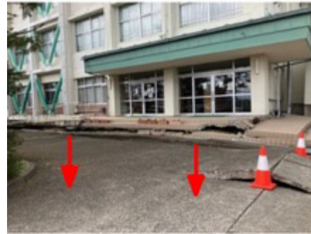
f) 周辺地盤が沈下した建物
