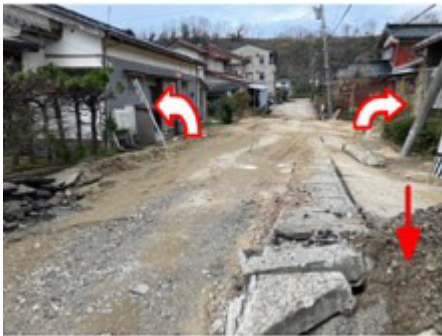
g) 地盤沈下と傾斜した電柱等
