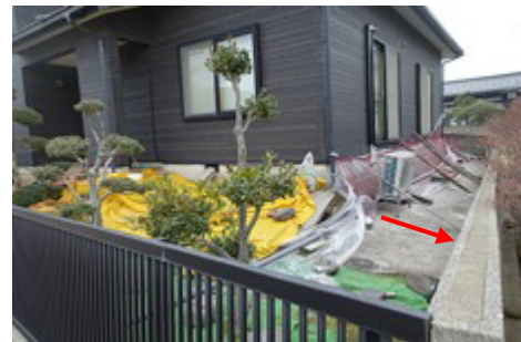
n) 住宅周辺の地盤変状
