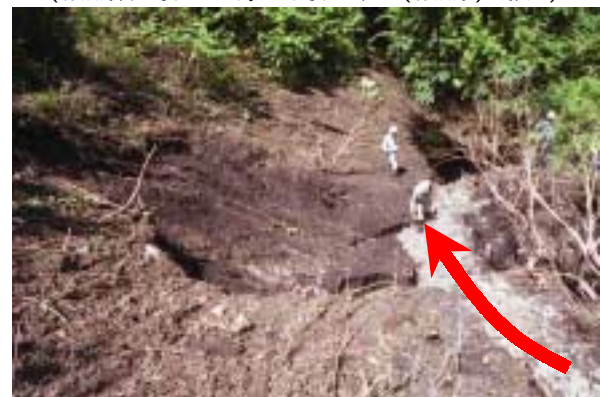
写真 - 3 途中の溪岸崩壊(赤点線内)
