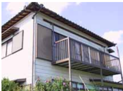
庇が突風で吹き飛ばされた住宅
