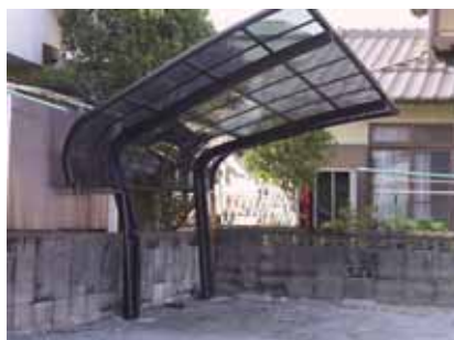
折れ曲がったカーポート
