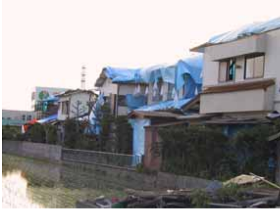
屋根等の被害
