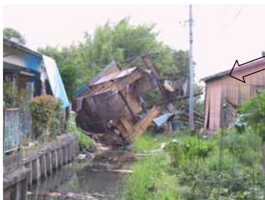
倒壊した家屋
