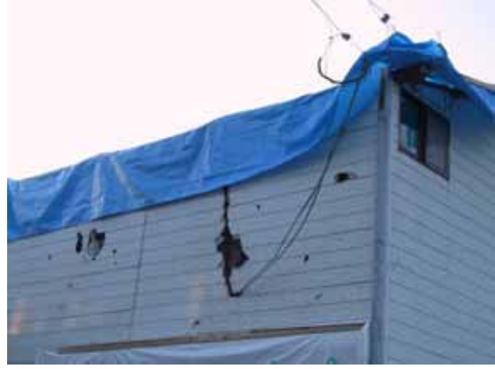
外装材の損傷（飛来物の衝突痕）
