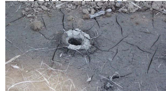
堤体の亀裂内の 噴砂
