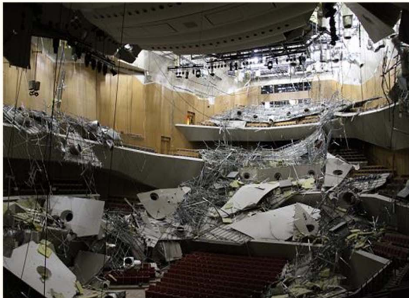
音楽ホールにおける天井の脱落
