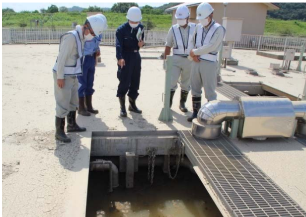
浸水した水処理施設の被害状況を確認する国総研職員
