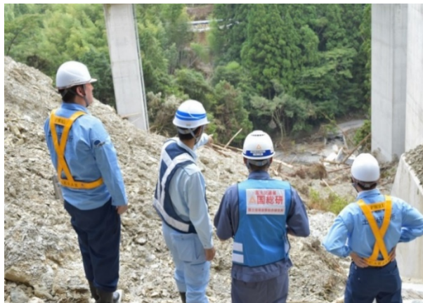
橋梁被災状況を調査する国総研職員
