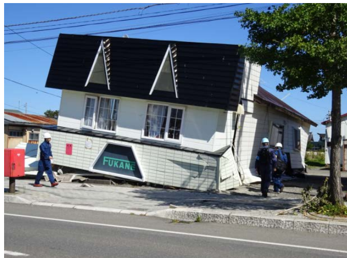
建築物被害の状況①
