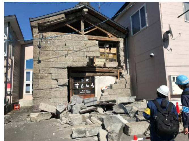
建築物被害の状況②
