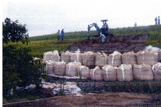
斐伊川右岸14.0kの法面陥没
