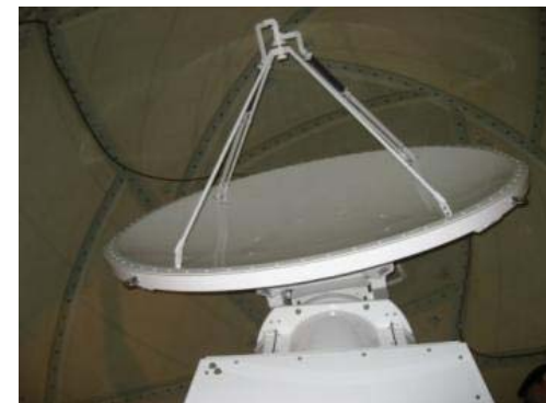
レーダアンテナ(埼玉サイト)
