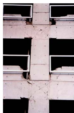
鉄筋コンクリート造建築物の柱はり接合部の損傷
