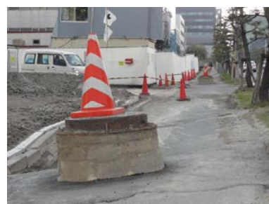
液状化によるマンホールの浮き上り
