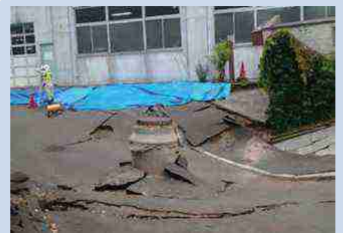
液状化によるマンホールの浮上 (被災箇所の管路属性を整理)
