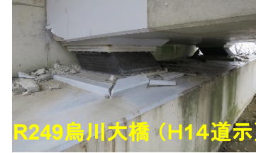
ゴム支承の残留変形
