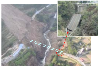
地盤変状の影響による落橋(阿蘇大橋)
