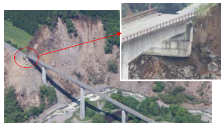
地盤変状の影響による橋台の沈下(阿蘇長陽大橋)
