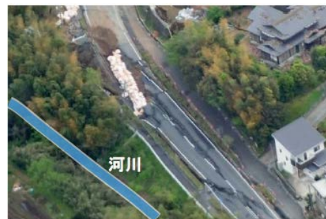
国道443号の盛土崩壊
