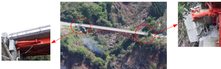
制震ダンパー取り付け部の損傷(南阿蘇橋)
