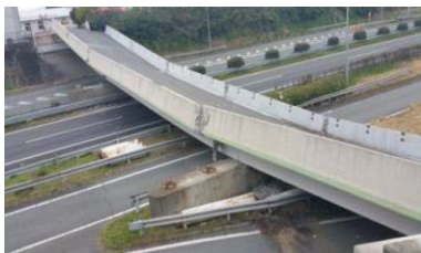
ロッキング橋脚を有する橋梁の落橋(県道小川嘉島線 府領第一橋)
