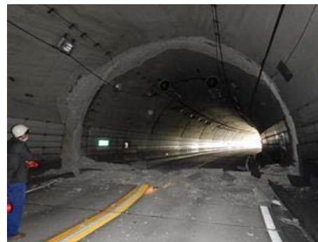
覆エコンクリートの崩落及び盤ぶくれ(俵山トンネル)
