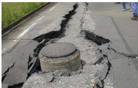
軟弱地盤に埋設された下水道管周辺で見られた路面陥没(益城町)
