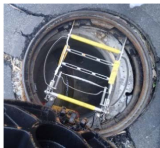
舗装の水平変位による蓋枠のズレ(熊本市)
