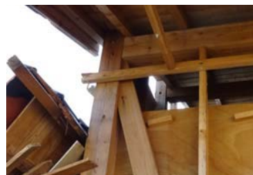
木造筋かい接合部に金物無し
