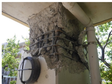
RC造建築物(ピロティ柱)の大破
