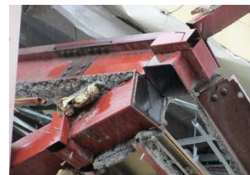
鉄骨造建築物の溶接部の破断
