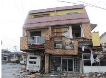
2階が崩壊した鉄骨造建築物
