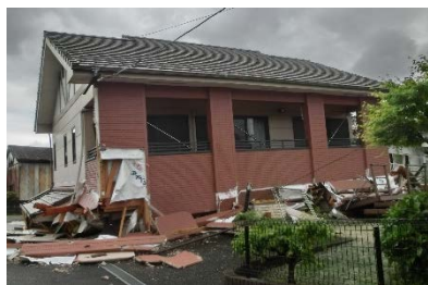
1階が倒壊した木造住宅
