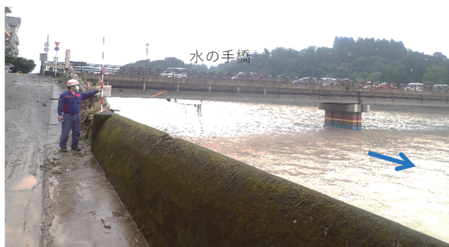
写真-4 球磨川右岸61.4k付近のパラペット堤の出水後の状況
