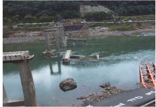
写真-11 下部構造が転倒した神瀬橋(8月25日撮影)
