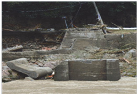
写真-13 橋脚が折損した深水橋(7月5日撮影)
