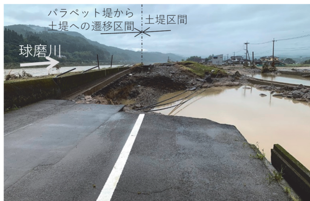
写真-3 球磨川右岸58.8k堤防欠損状況
