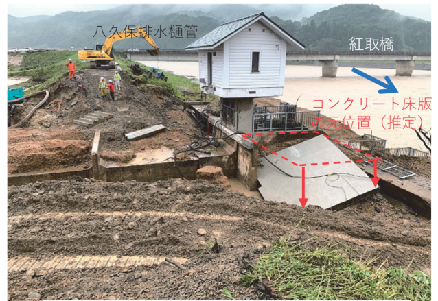
写真-2 球磨川右岸56.4k堤防決壊状況
