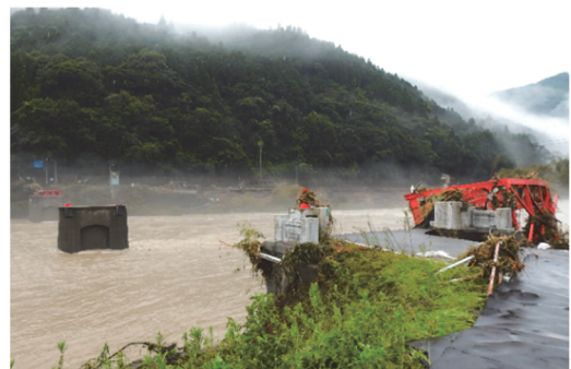
写真-12 上部構造が流出した相良橋(7月7日撮影)
