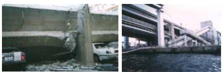
出典：気象庁、阪神淡路大震災の記録、むき出しの鉄筋（左写真）・沿岸部被災地（右図）
