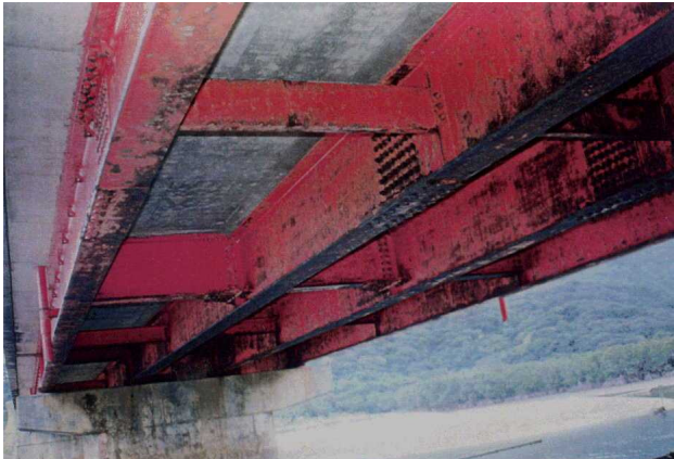
図－3 道路橋上部工主桁の腐食
