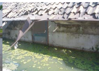
写真 - 2 家屋の水没状況 (スマラン)
