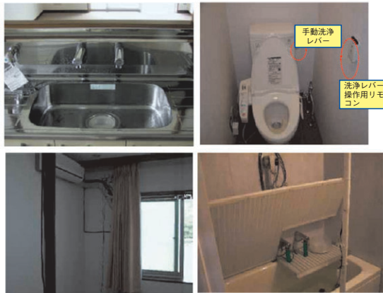
図-3 台所の給湯給水弁（左上）、トイレの暖房便座・温水シャワー器具（右上）、窓・カーテンの開閉操作、冷暖房設備の発停（左下）、浴槽の給湯給水弁及びフタの開閉操作（右下）の自動運転
