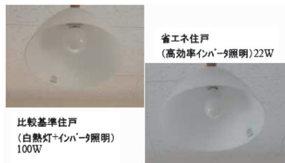
図-4 (3) 比較基準住戸と省エネ住戸に設置された照明器具の一部
