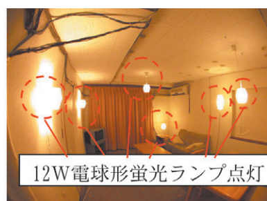
写真-2 多灯分散の点灯例 (リビング・ダイニング)
