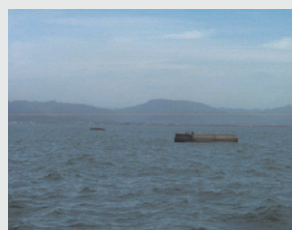
写真-3 函館港防波堤(被災後)
