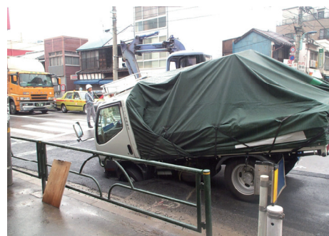
図-1 道路陥没発生状況 2)
