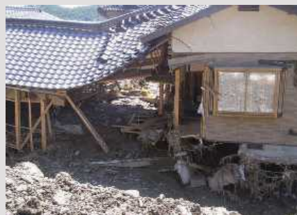
図－2 久崎地区破堤箇所近傍の家屋
