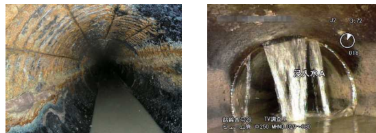
写真1 不具合のある管きよ内の状況例
