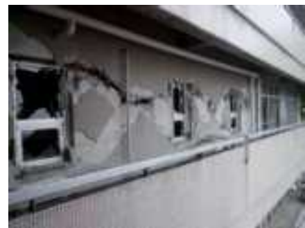
写真2 地震による非構造壁の被害
