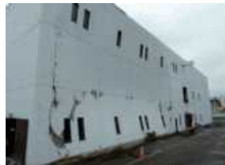
写真1 津波による建物被害
