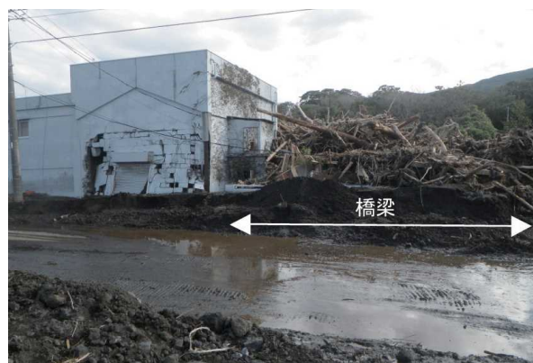
写真-2 流木による橋梁の閉塞(元町橋)
