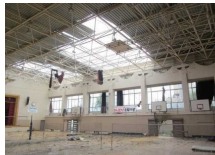
写真1 文教施設A体育館における被害
