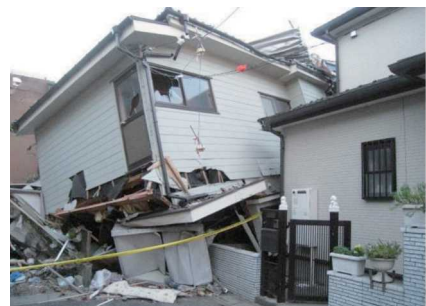
写真2 木造住家における上部構造の倒壊
