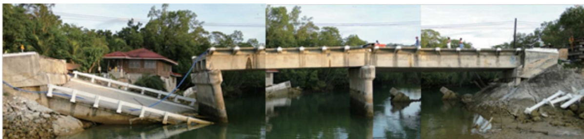
写真 Moalong Bridge (1982年建設)の被災状況
